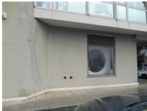
Prospetto del fabbricato - negozio al piano terra - infisso sul fronte lato parcheggio e strada pubblica.
