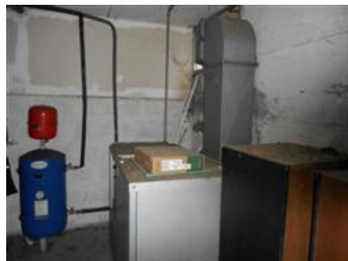
Interno della cantina/C.T. posta al piano seminterrato (ove vi sono le autorimesse dell'edificio)
