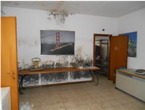
Locale sala riunioni - segni di infiltrazioni meteoriche dal tetto - attualmente riparato alcuni anni fa
