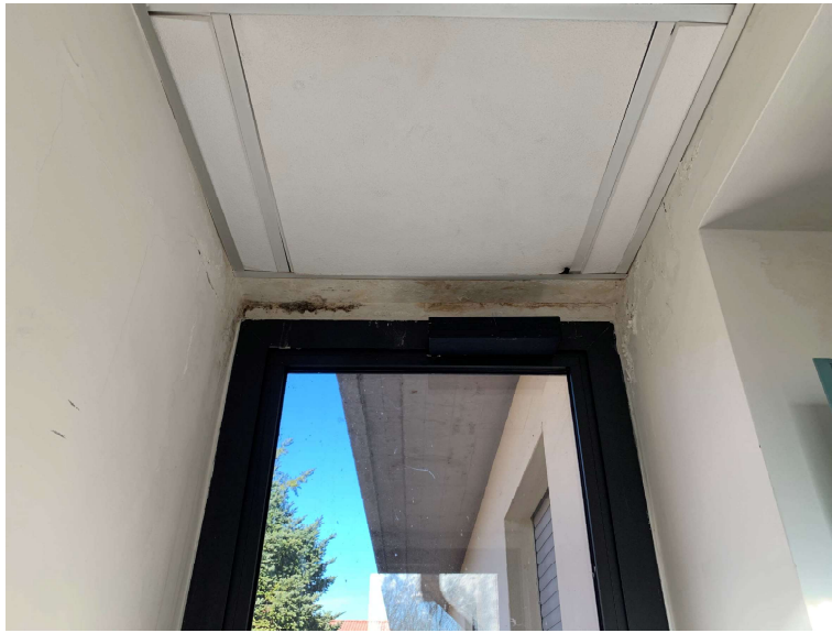
Particolare infiltrazioni di umidità c/o sbarco montalettighe secondo piano
