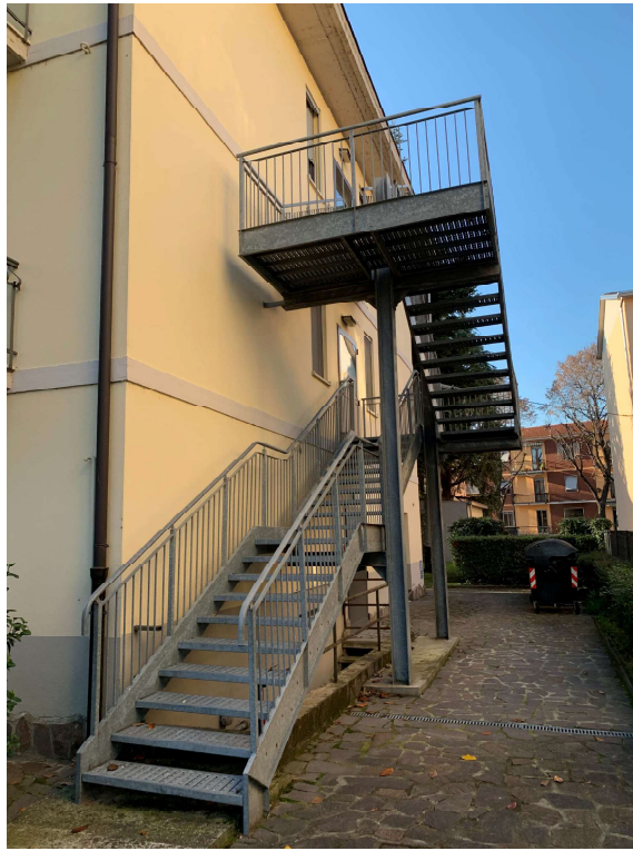
Dettaglio scala metallica antincendio
