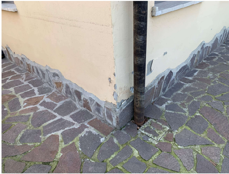
Porzione di intonaco ammalorato
