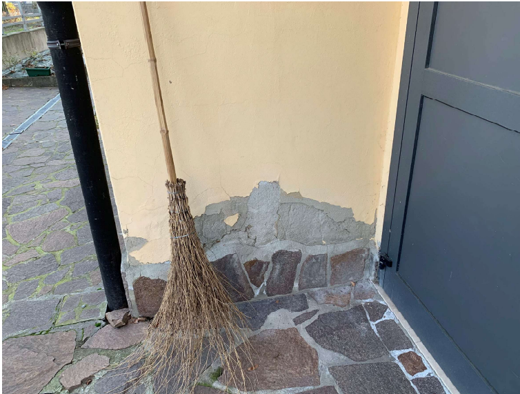
Porzione di intonaco ammalorato
