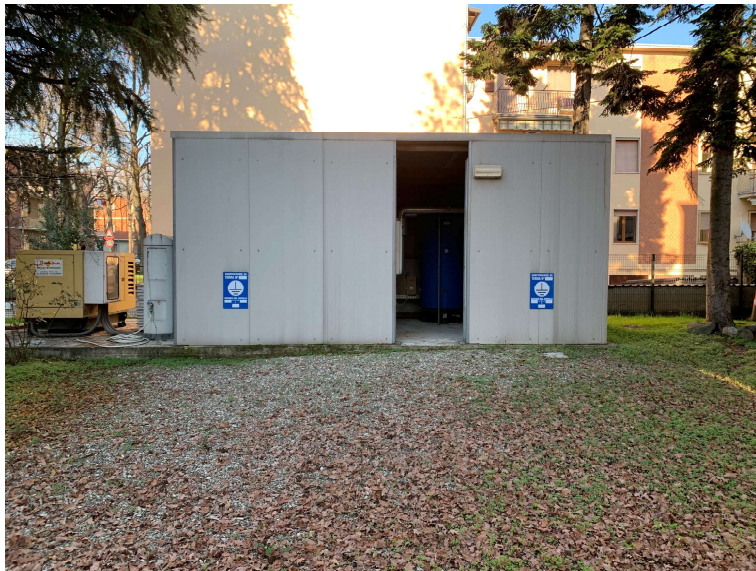
Vista piazzola macchine condizionamento
