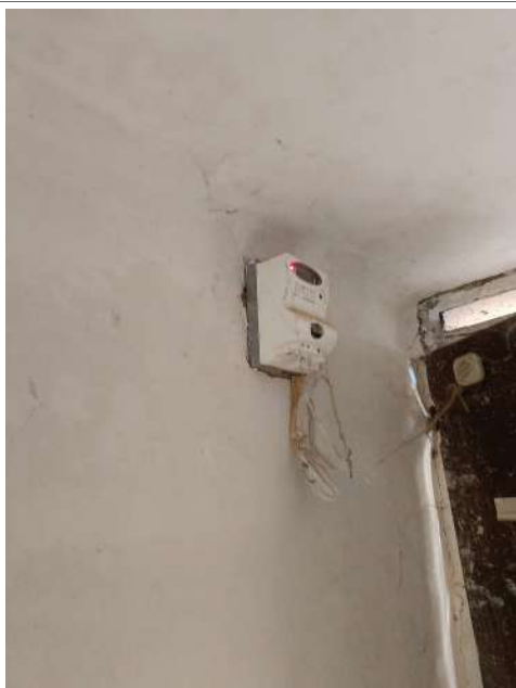
Contatore luce disimpegno p.terra
