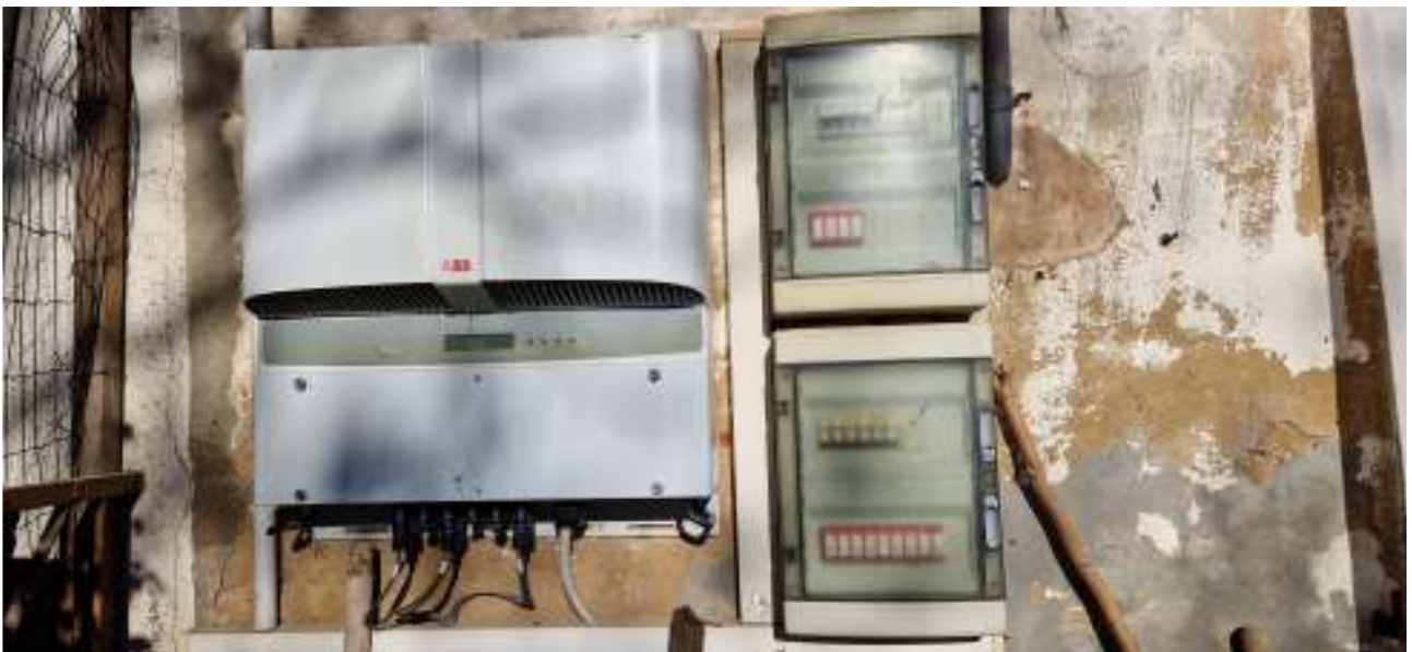
Vista del quadro elettrico
