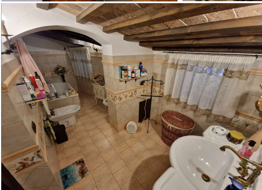
(Bagno con ampliamento abusivo nel cavedio)
