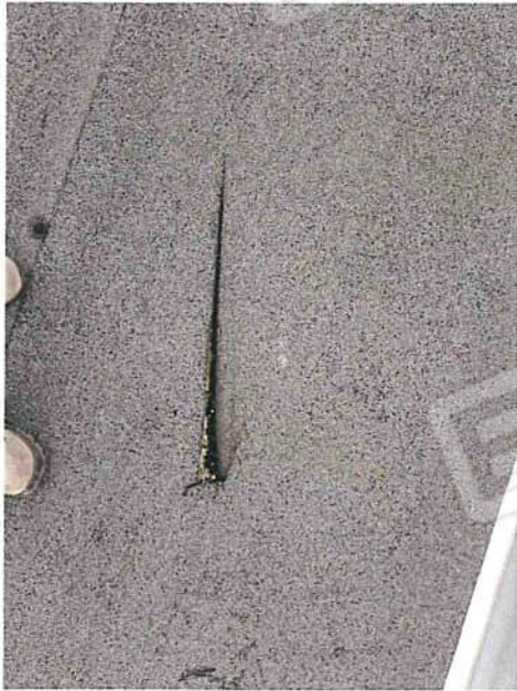
Foto 127 - Copertura guaina lesionata.jpg
