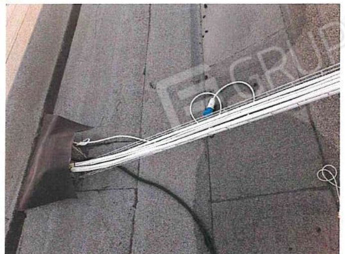
Foto 132 - Copertura canalina cavi elettrici.jpg
