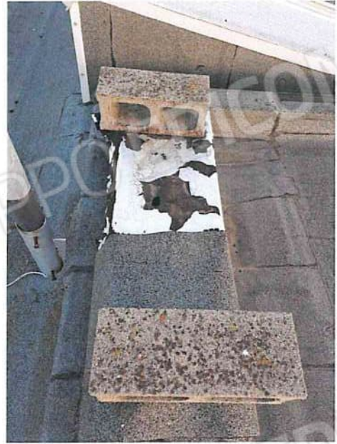
Foto 164 - Copertura presa d'aria.jpg
