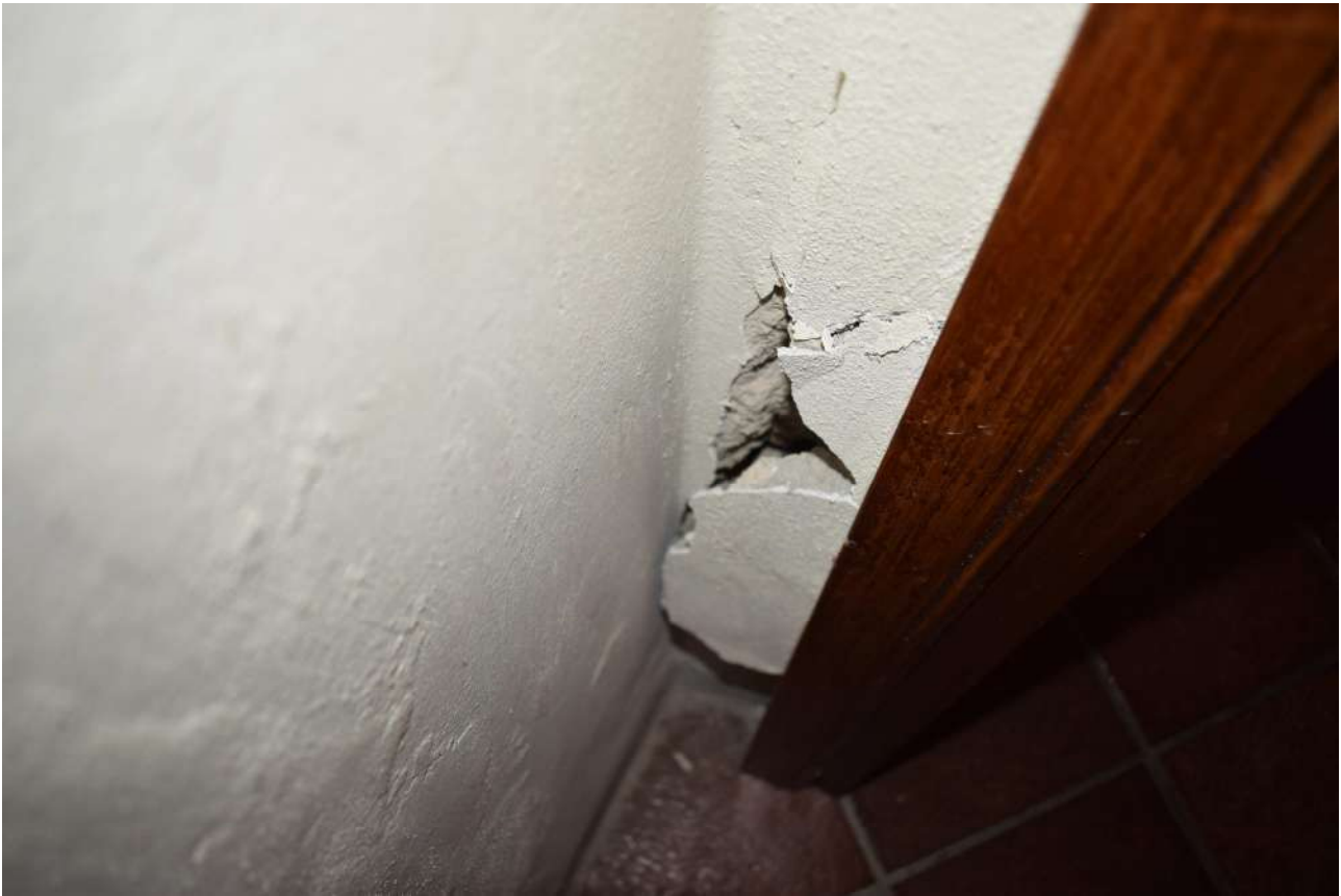
Foto n. 133 _ Sopralluogo del 05/10/2021 Particolare di degrado degli stipiti
