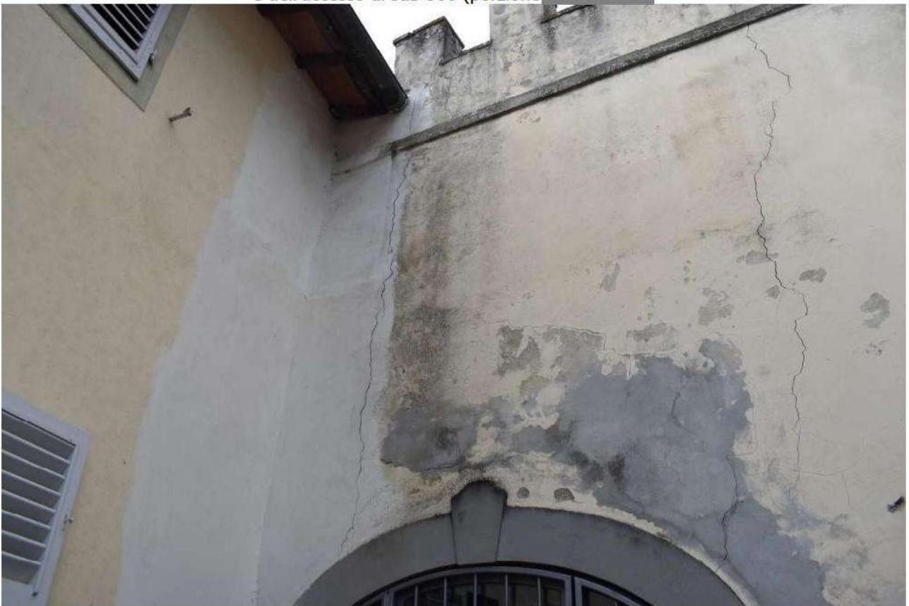
Foto n. 8 _ Sopralluogo del 05/10/2021 Particolare della facciata in corrispondenza dell'accesso al sub 500. Si notano crepe e rimpelli.
