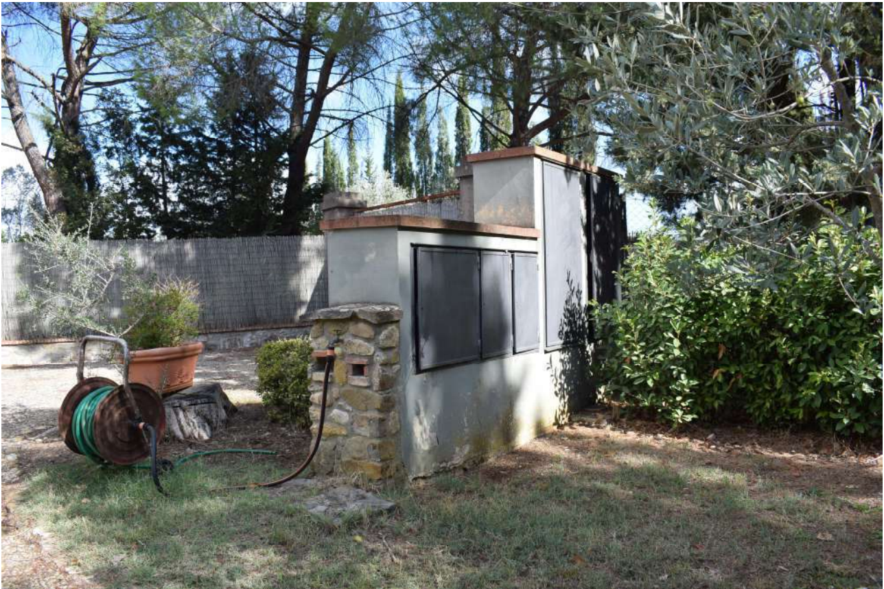
Foto n. 44 _ Sopralluogo del 05/10/2021 Vani contatori
