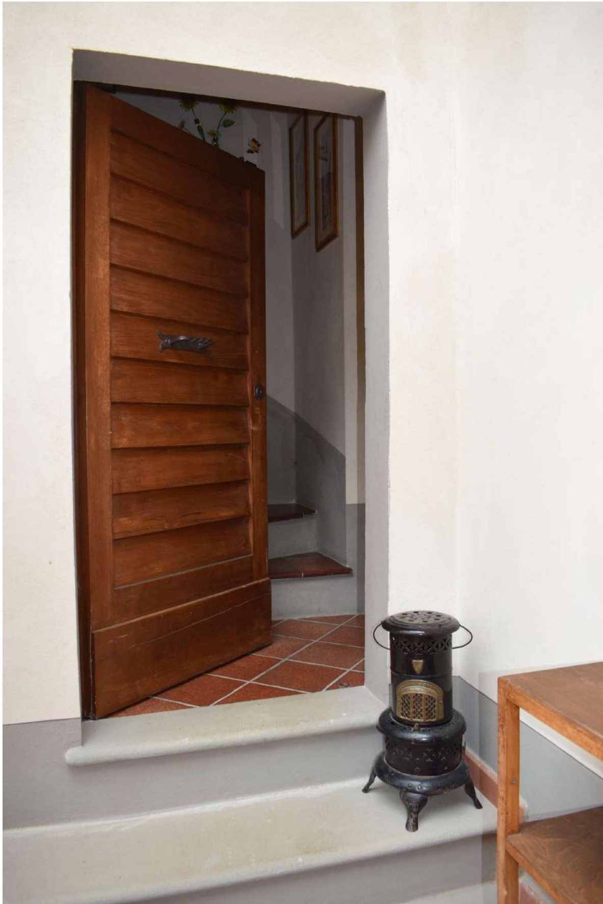
Foto n. 64 _ Sopralluogo del 05/10/2021 Dalla corte chiusa questa porta conduce al piano primo (porzione XXXXXXXXXX )
