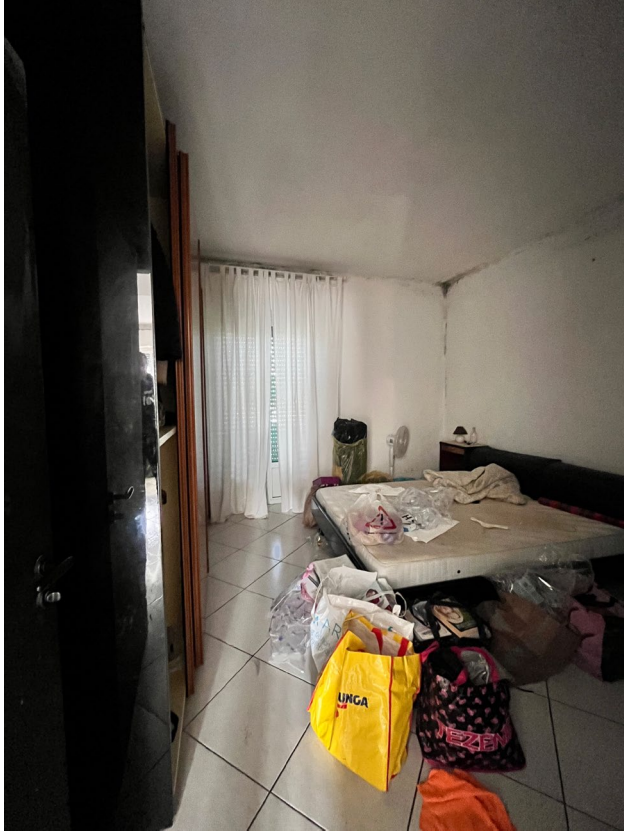
Immagine 46. La seconda camera, con analoghi problemi di umidità e muffe.
