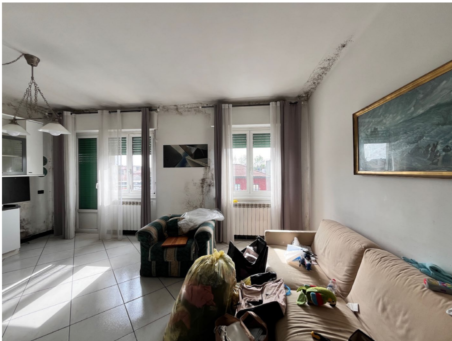
Immagine 43. Il soggiorno con alla sinistra dell'immagine lo spazio cottura. Si nota la presenza di muffa conseguente ad infiltrazioni dal tetto o per effetto di un ponte termico (la parete dietro la cucina è esposta a Nord).
