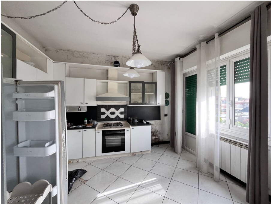
Immagine 44. Lo spazio cottura. Si nota la presenza di muffa conseguente ad infiltrazioni dal tetto o per effetto di un ponte termico (la parete dietro la cucina è esposta a Nord).
