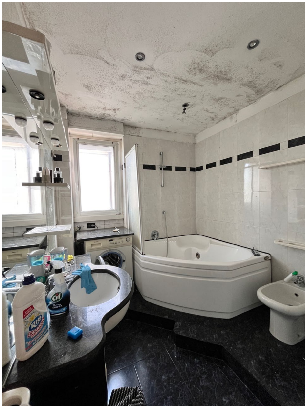
Immagine 47. Il bagno che non viene risparmiato da problemi di umidità e muffe, conseguenti ad infiltrazioni dal tetto o per effetto di un ponte termico (la parete dietro la cucina è esposta a Nord).
