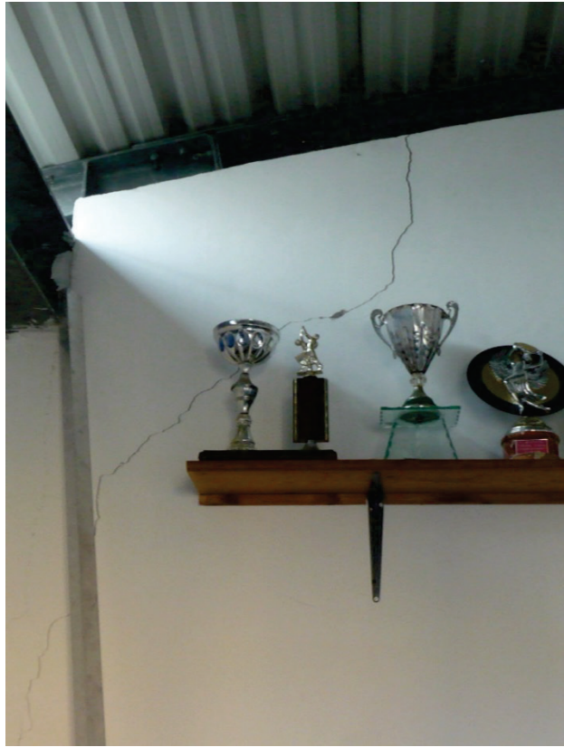
Foto n 49 PP locale segreteria particolare fessurazione
