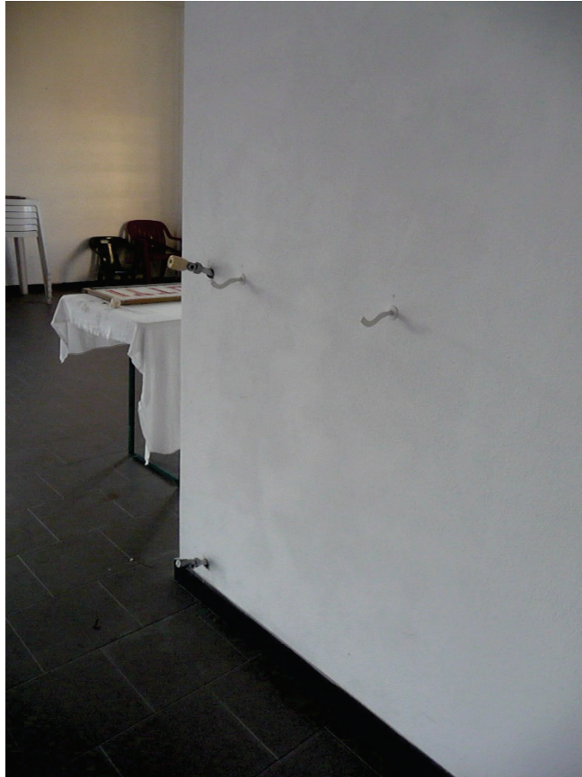
Foto n 31 impianti di riscaldamento con attacchi caloriferi sottratti
