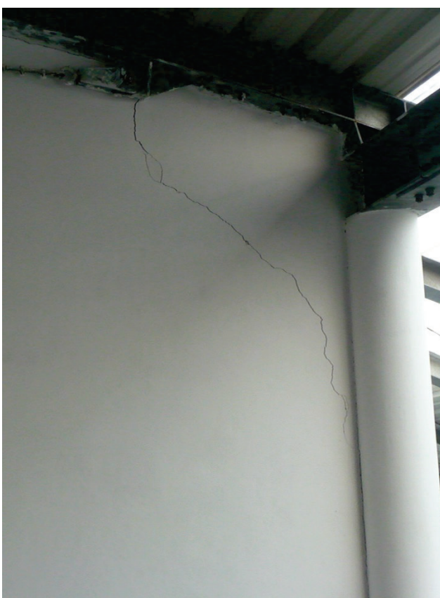
Foto n 46 ballatoio su soppalco dettaglio: fessurazioni
