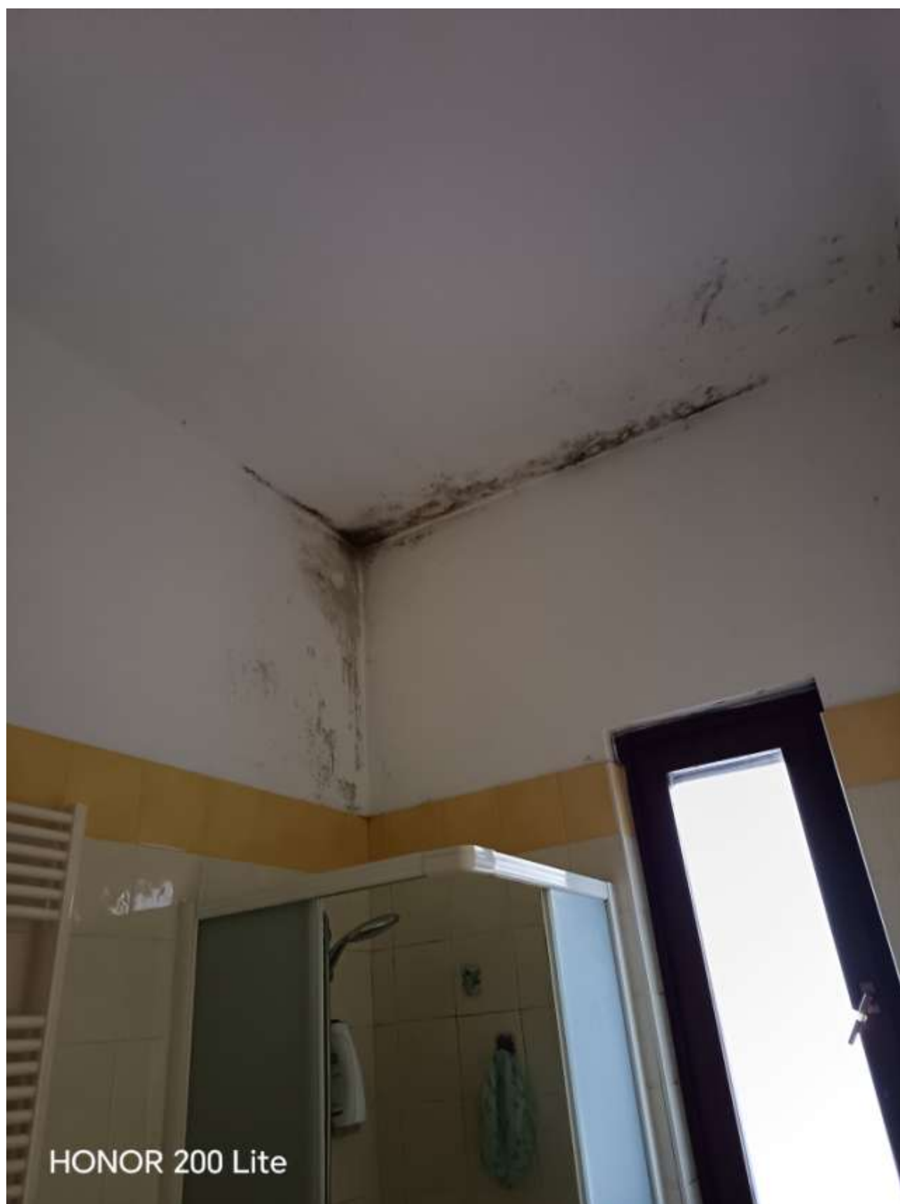
Figura 14 - PARTICOLARE INFESTAZIONE DA MUFFE
