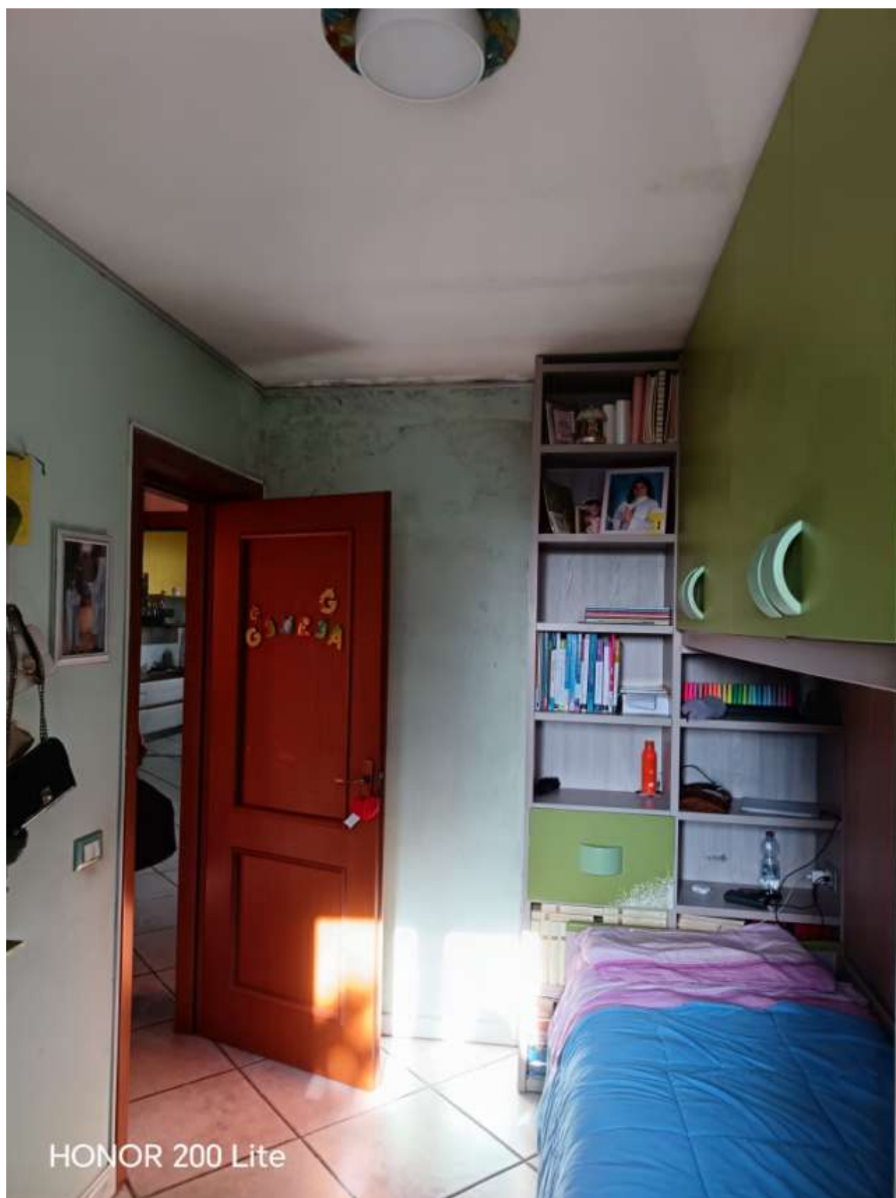
Figura 13 - PARTICOLARE INFESTAZIONE DA MUFFE
