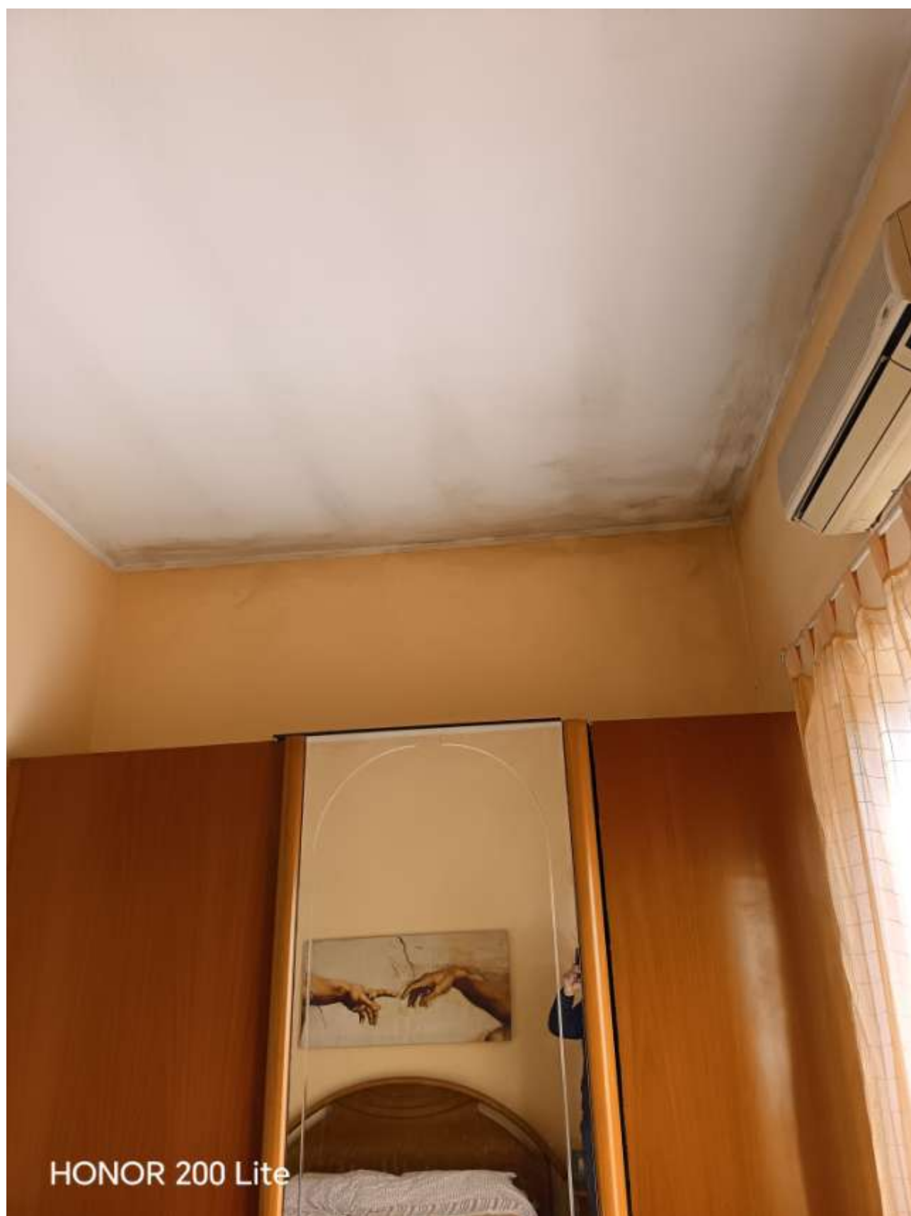
Figura 12 - PARTICOLARE INFESTAZIONE DA MUFFE
