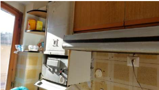
Foto nr.25: particolare caldaia
