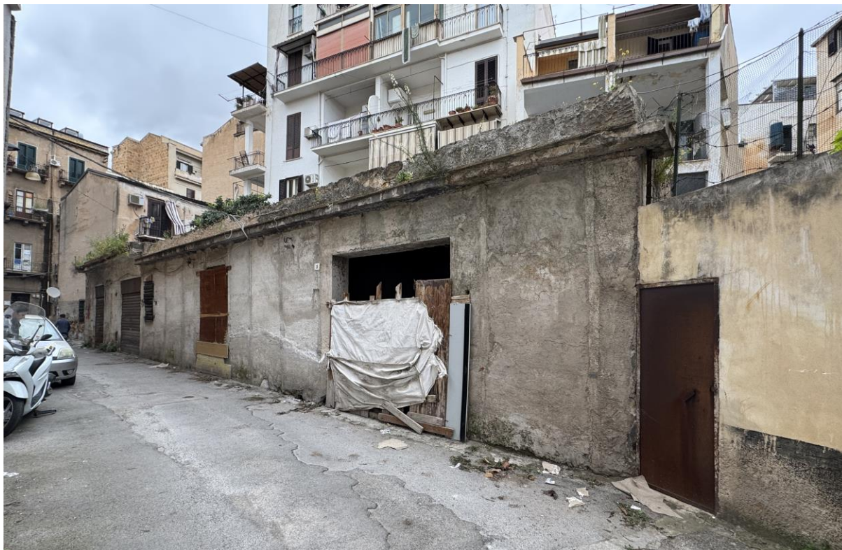
Foto n. 3 - l'immobile costituito dal solo piano terra, veduta su strada. L'ingresso privo di infisso o saracinesca è chiuso con tavole di legno e teloni. L'edificio presenta l'intonaco ma non la finitura.
