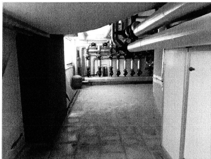
Foto n. 49 – Piano soppalco - locale unità trattamento aria
