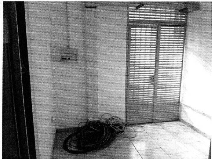
Foto n. 66 – Piano soppalco - locale ced
