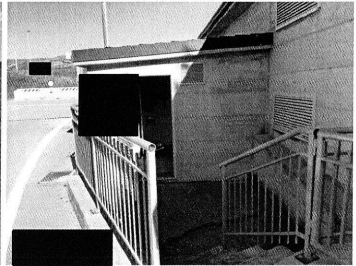
Foto n. 94 – Cabina elettrica - Part. 1120 sub 5
