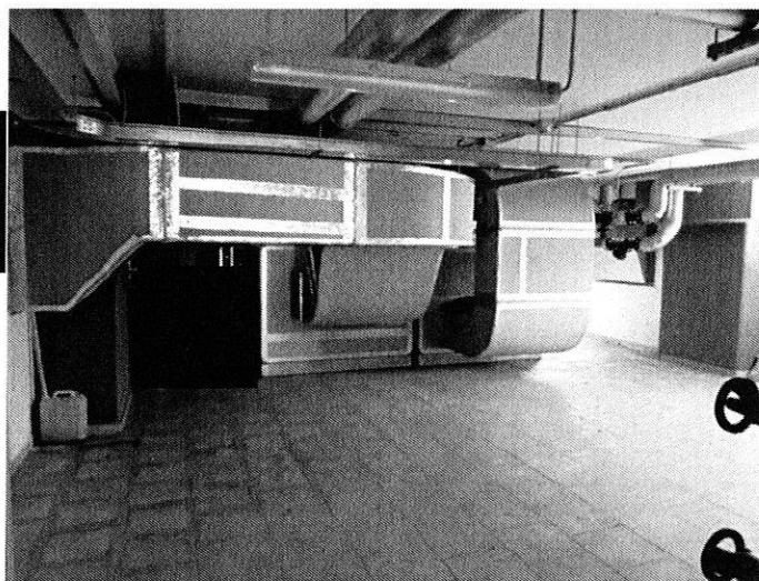
Foto n. 48 – Piano soppalco - locale unità trattamento aria
