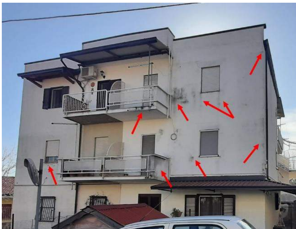
Foto 15. Zone ammalorate su uno dei prospetti.
