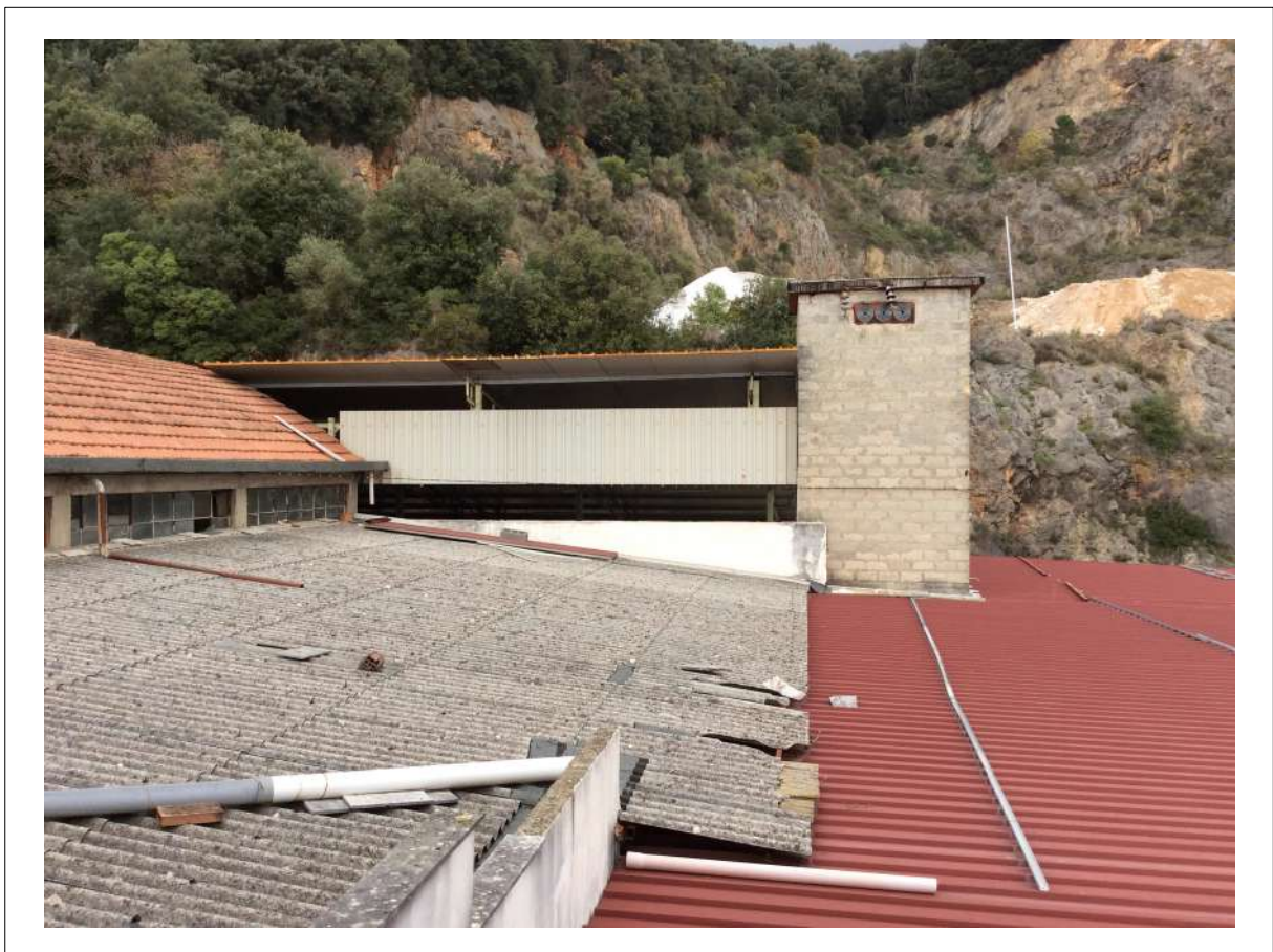
FOTO 62: Palazzina Piano PRIMO - Vista dal Balcone di accesso verso Nord-Est - Dettaglio delle Coperture e del loro stato di conservazione.
