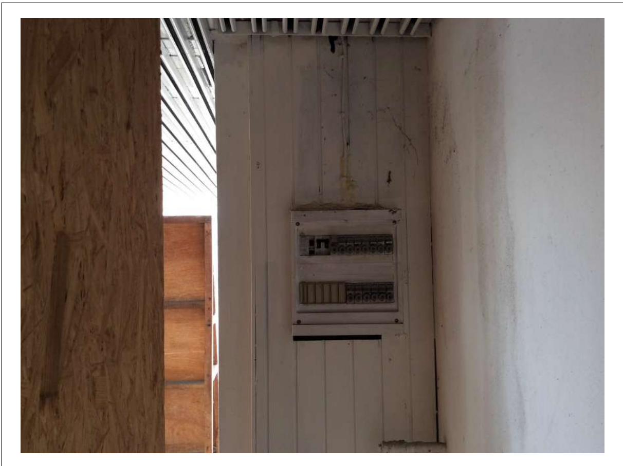
FOTO 46: Palazzina Piano TERRA - Dettaglio del Quadro Elettrico di zona.
