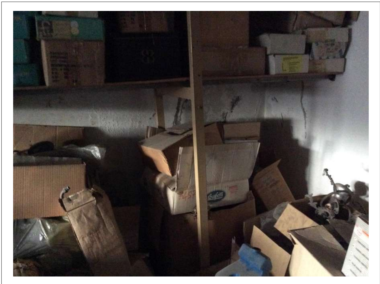
FOTO 60: Palazzina Piano PRIMO - Dettaglio dell'umidità presente sulla parete posta a contatto con il tetto del Capannone centrale.
