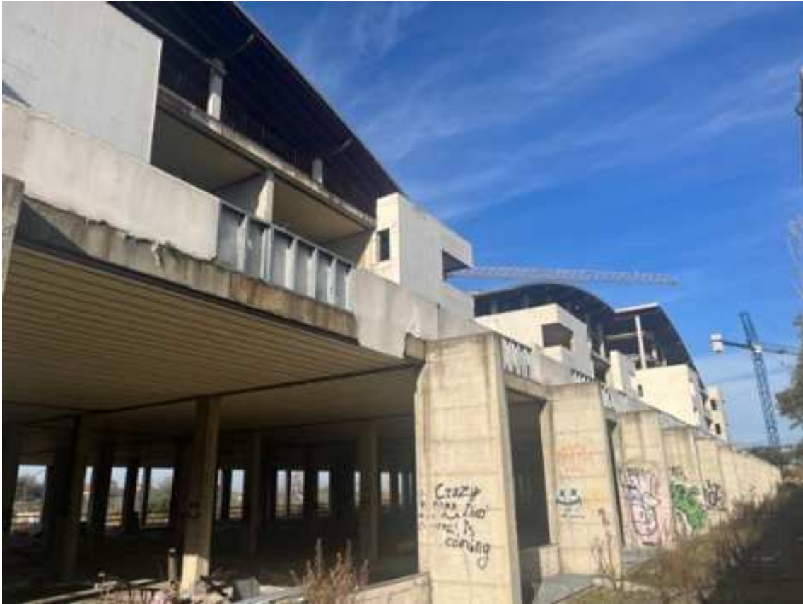
Fig.3 – Vista dell’immobile posto sui terreni al Fg 36 P.lle 4415-4418 dall’ingresso posto a sud est (primo piano interrato)
