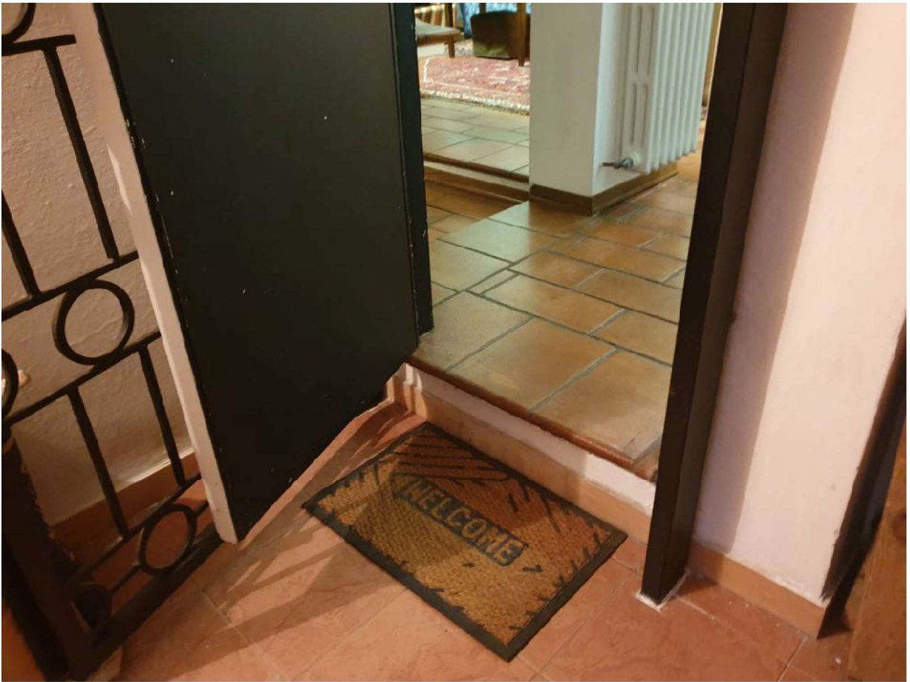
FOTO 38. Dislivello tra interno a piano terra e garage
