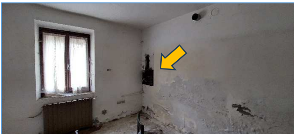
Alloggiamento caldaia assente
