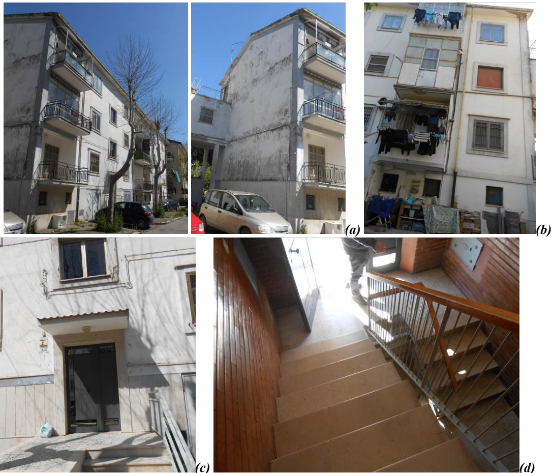
Figura n° 2. Fotografie del fabbricato: prospetto principale e laterale di via Giulio Cesare (a); facciata posteriore (b); portone del civico 10/A (c); scalinata condominiale (d).
