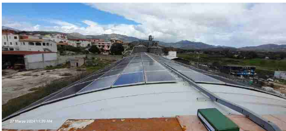
Figura 8_Vista d'insieme dei pannelli fotovoltaici, delle strutture metalliche di supporto e delle canalette passacavi
