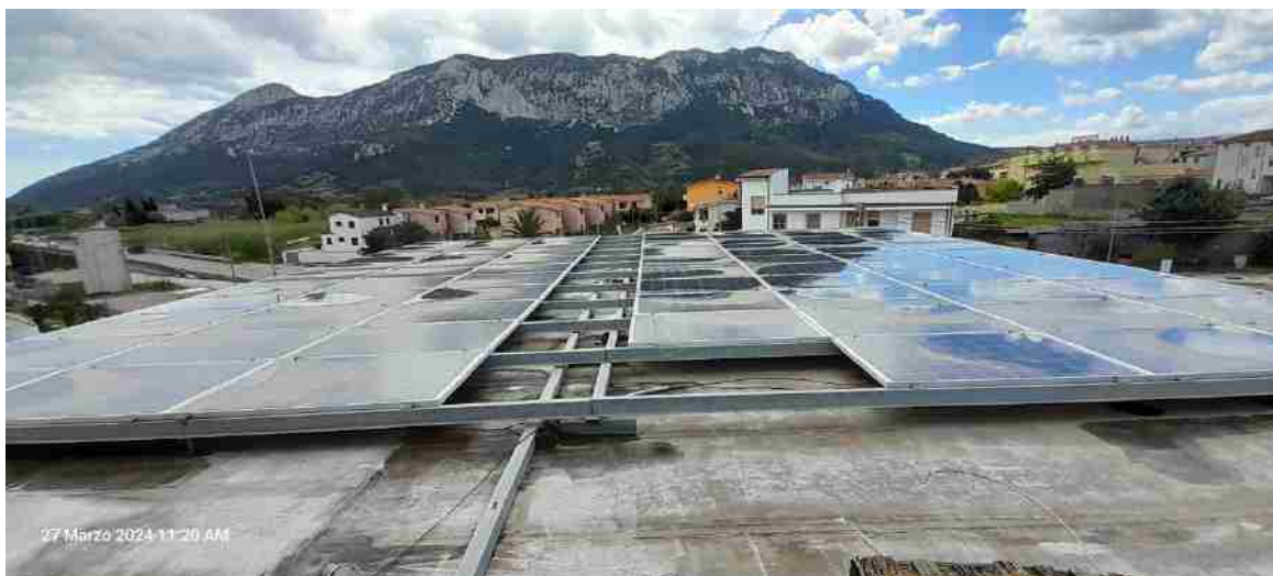
Figura 5_Vista d'insieme dei pannelli fotovoltaici, delle strutture metalliche di supporto e delle canalette passacavi
