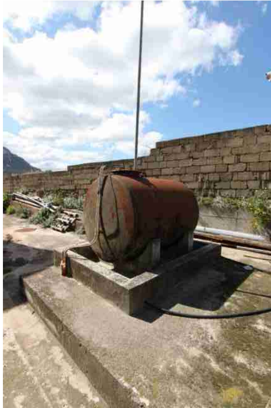
Figura 69_Area deposito gasolio per caldaia
