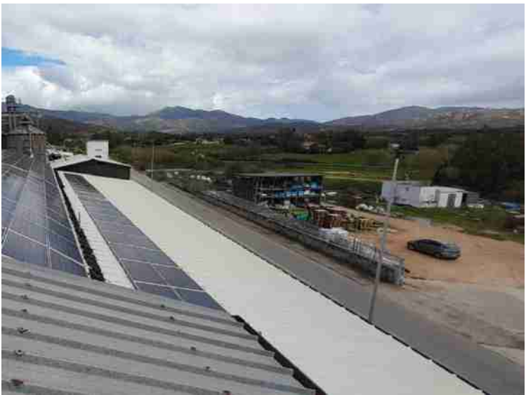
Figura 12_Vista d'insieme dei pannelli fotovoltaici, delle strutture metalliche di supporto
