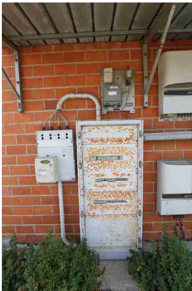
Figura 16_Vista dei quadri e contatori del 22/03/2024
