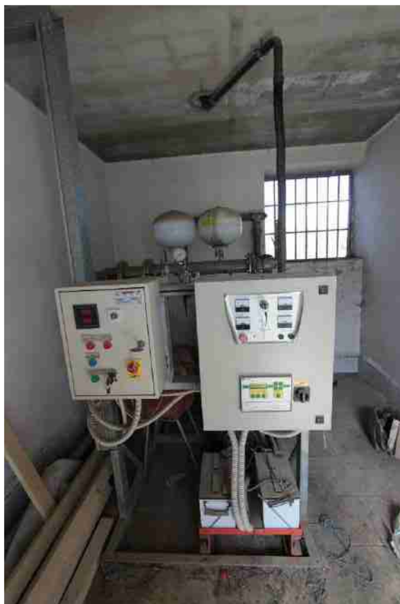
Figura 16_Quadri di comando pompe antincendio sub.1
