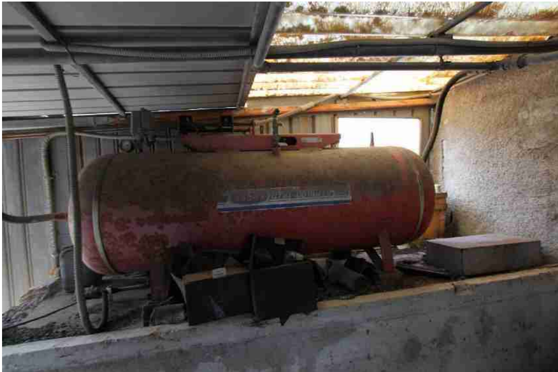
Figura 68_Area deposito aria compressa Fini
