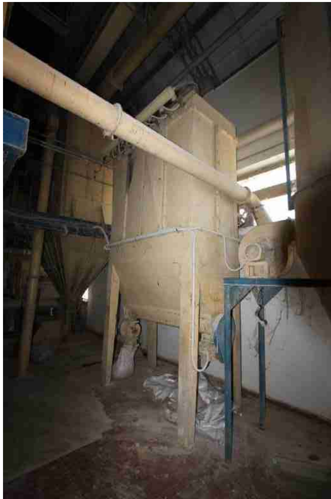
Figura 99_Filtro per mulino a martelli e celle di pre-macinazione retrostanti
