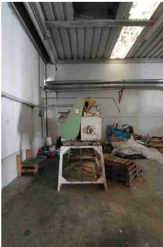
Figura 30_Impianto di insaccaggio Cani Immac
