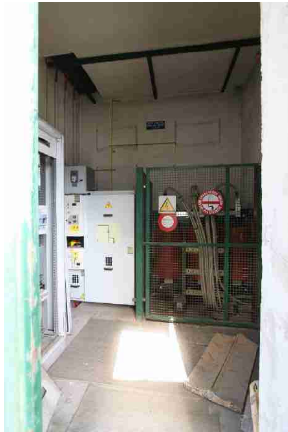
Figura 58_ Quadri elettrici cabina enel
