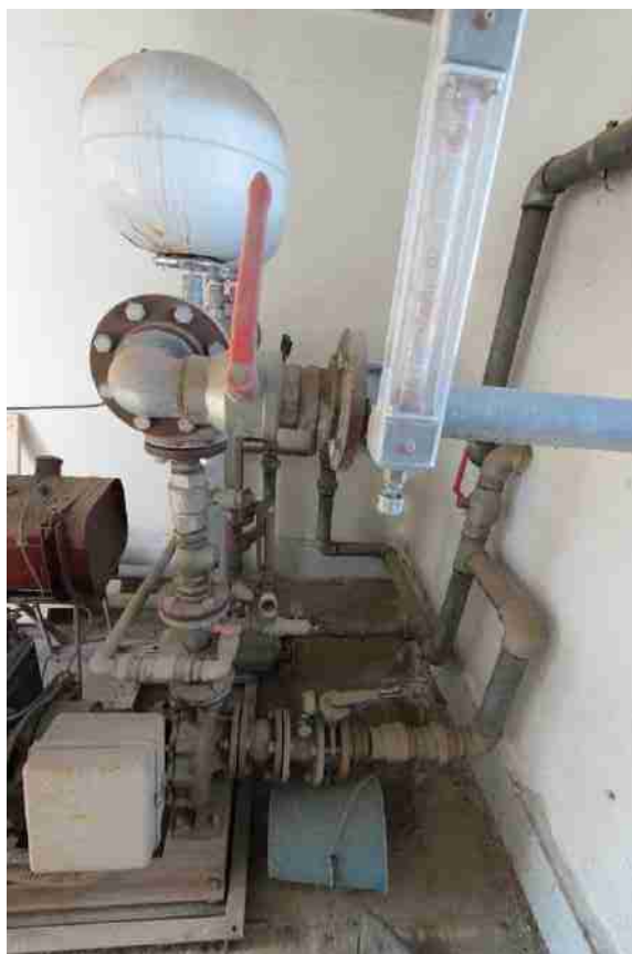
Figura 18_Vasi di espansione antincendio
