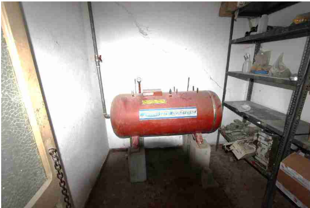
Figura 109_Sala aria compressa
