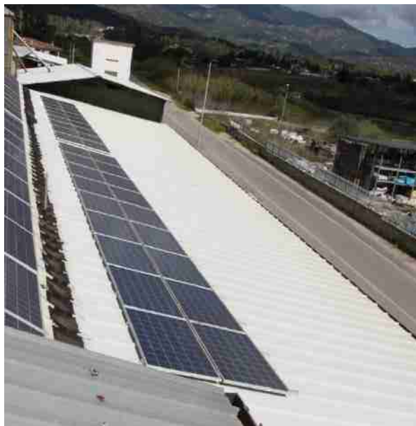
Figura 13_Vista d'insieme dei pannelli fotovoltaici, delle strutture metalliche di supporto
