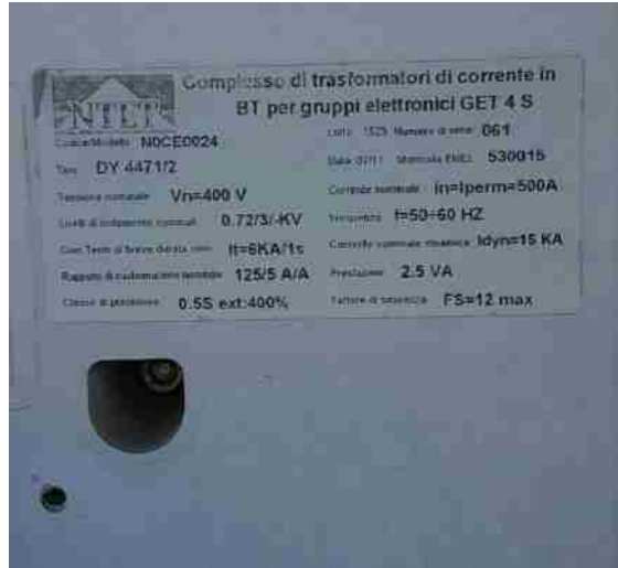
Figura 20 _Dettaglio del trasformatore
