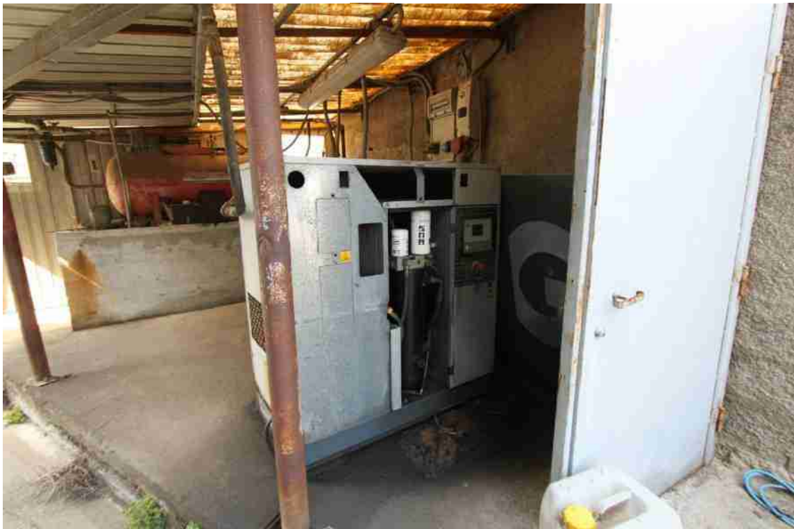
Figura 66_Area compressore Atlas Copco GA15
