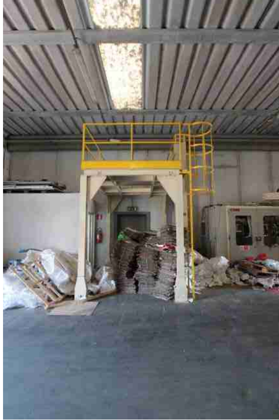
Figura 22_Castelletto per tramoggia di carico ed insaccaggio
