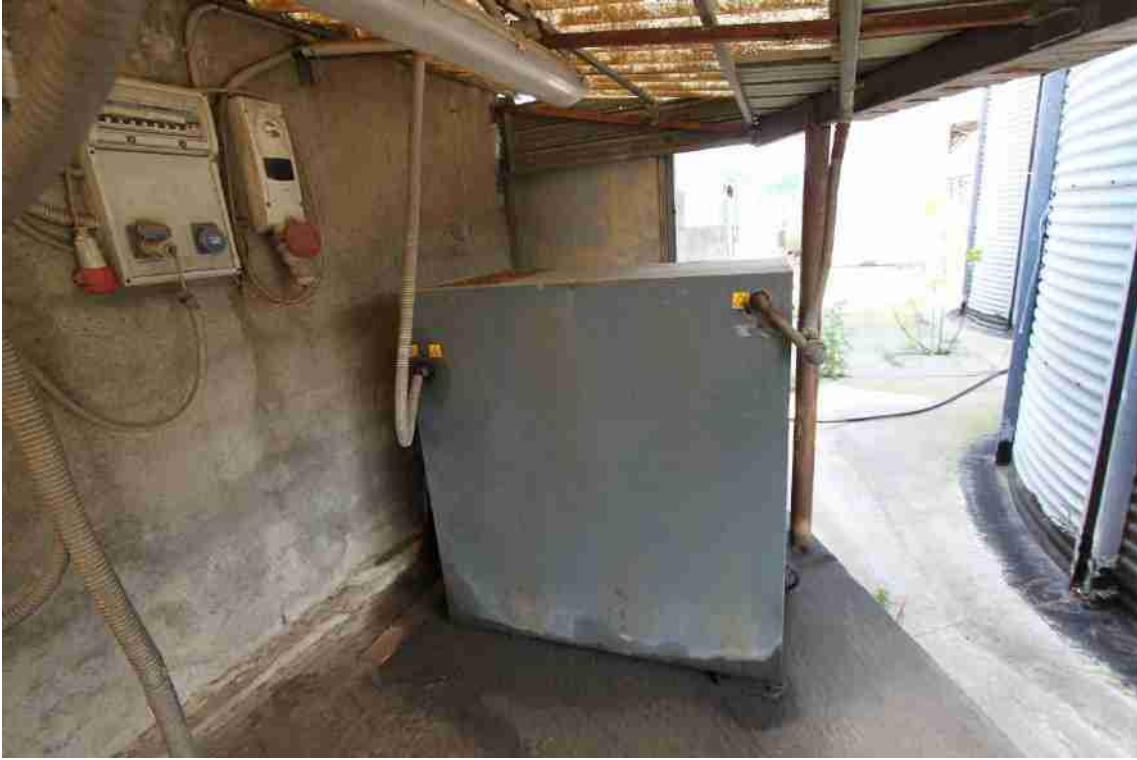
Figura 67_Area compressore Atlas Copco GA15
