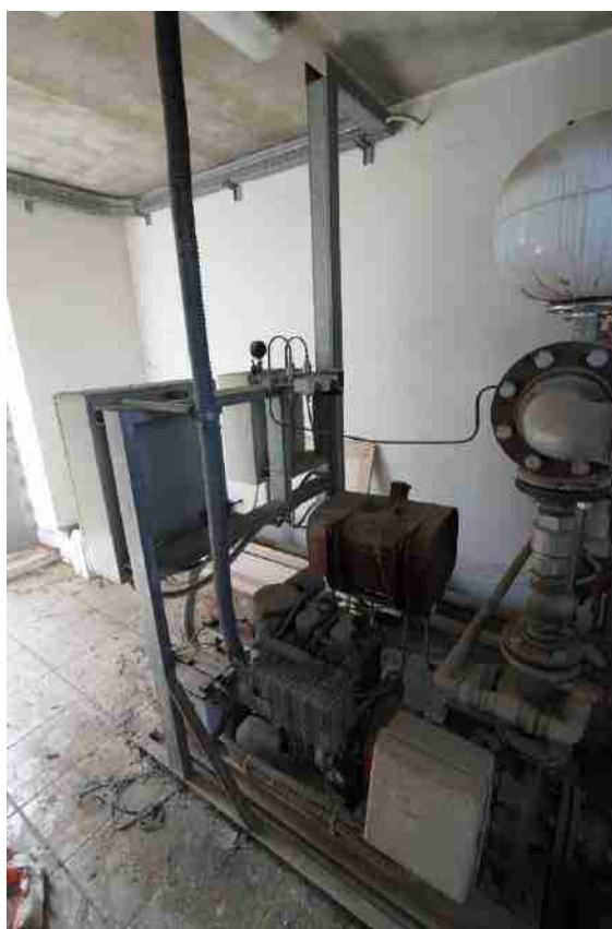
Figura 17_Motopompa gruppo antincendio
