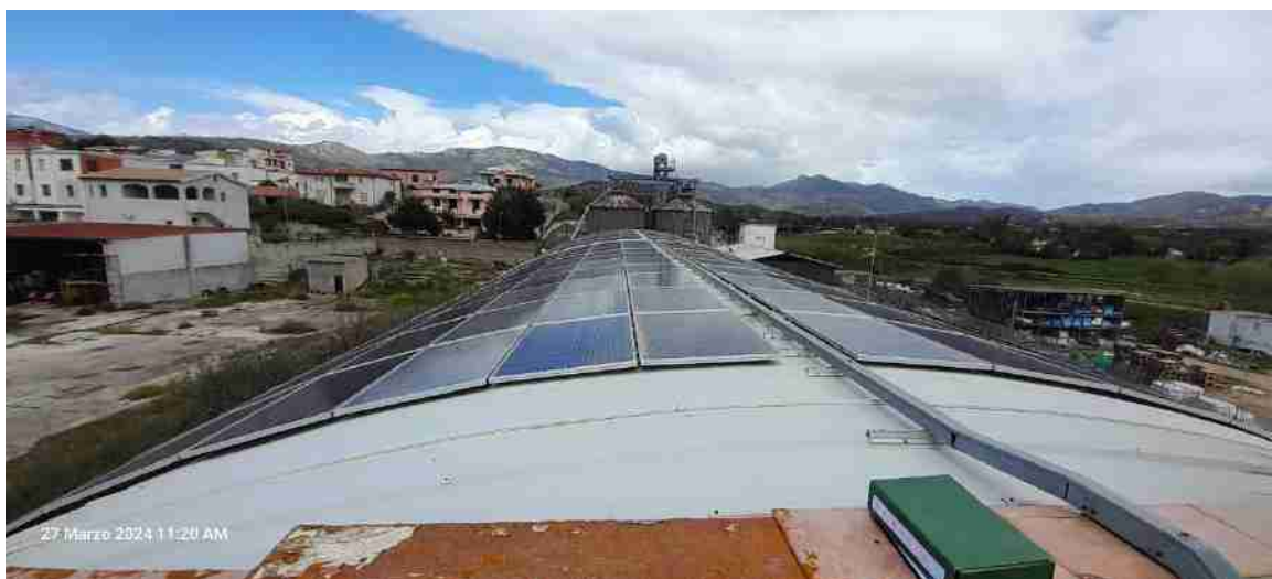
Figura 51_Impianto fotovoltaico sul tetto a volta dello stabilimento produttivo
