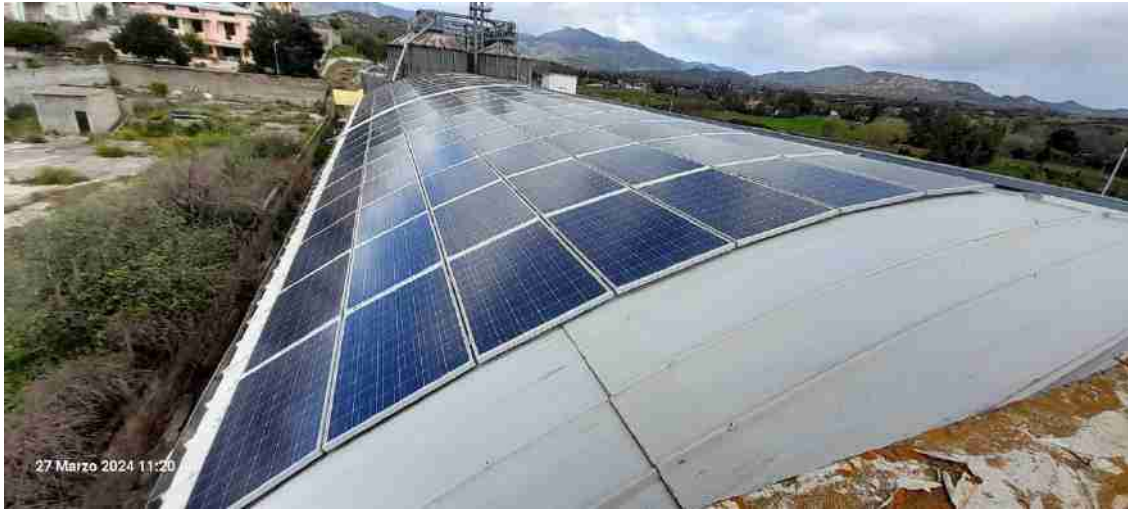
Figura 52_Impianto fotovoltaico sul tetto a volta dello stabilimento produttivo
