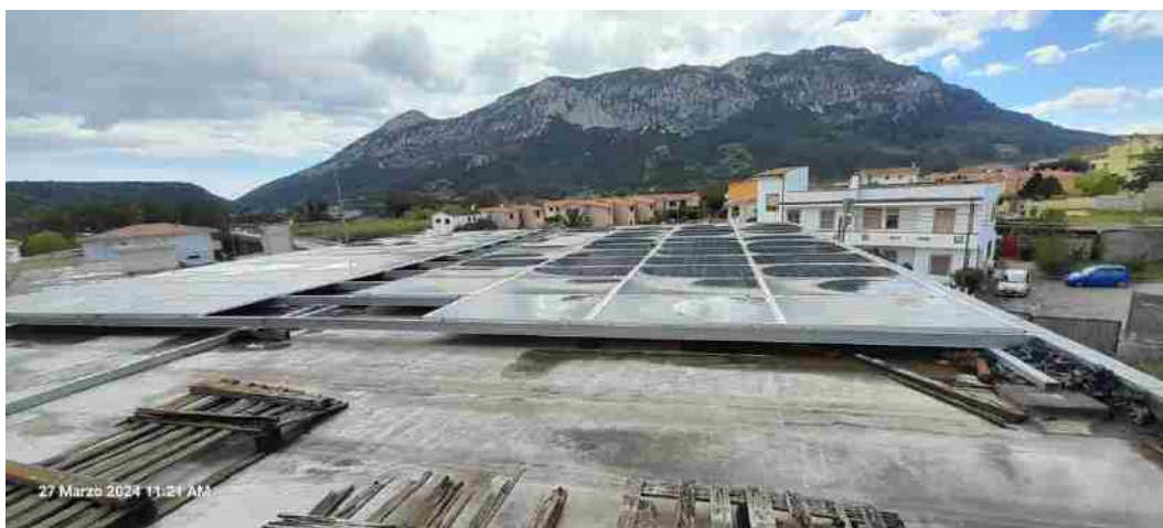
Figura 6_Vista d'insieme dei pannelli fotovoltaici, delle strutture metalliche di supporto e delle canalette passacavi
