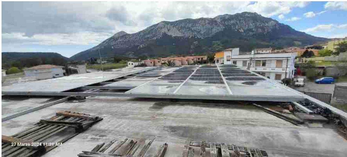
Figura 50_Impianto fotovoltaico sul tetto piano di copertura degli uffici e casa del custode
