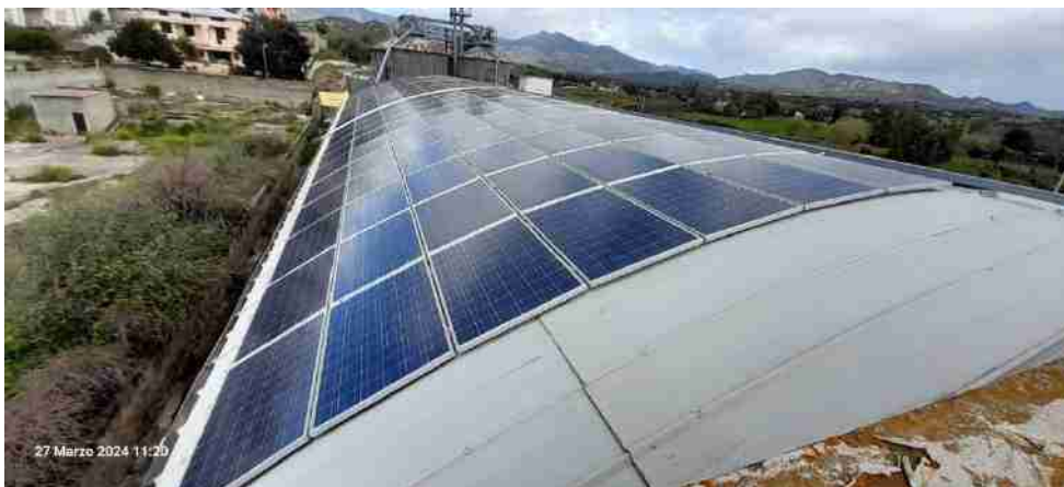
Figura 9_Vista d'insieme dei pannelli fotovoltaici, delle strutture metalliche di supporto e delle canalette passacavi
