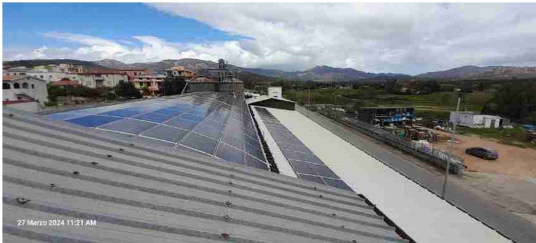
Figura 53_Impianto fotovoltaico sul tetto a volta dello stabilimento produttivo e della pensilina
