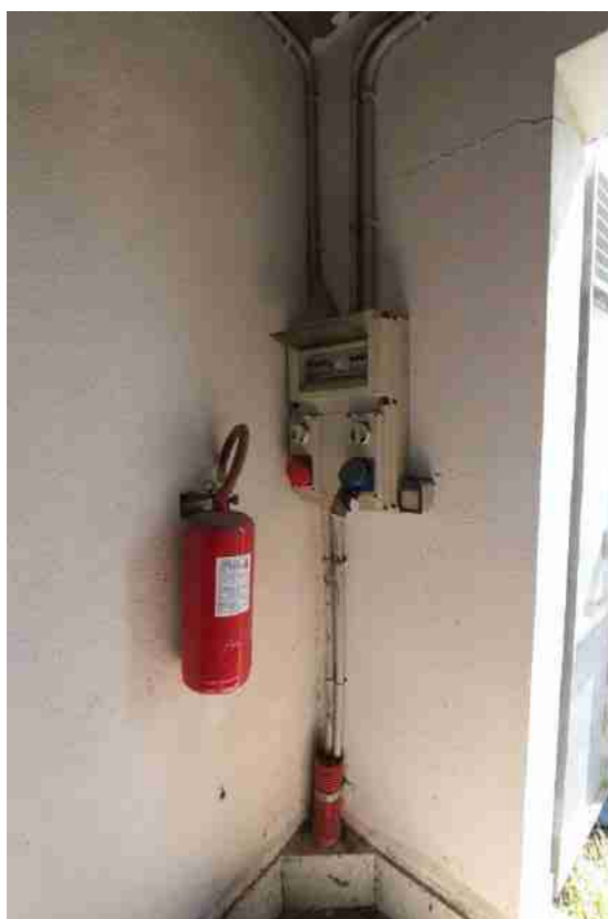
Figura 19_Quadro elettrico antincendio
