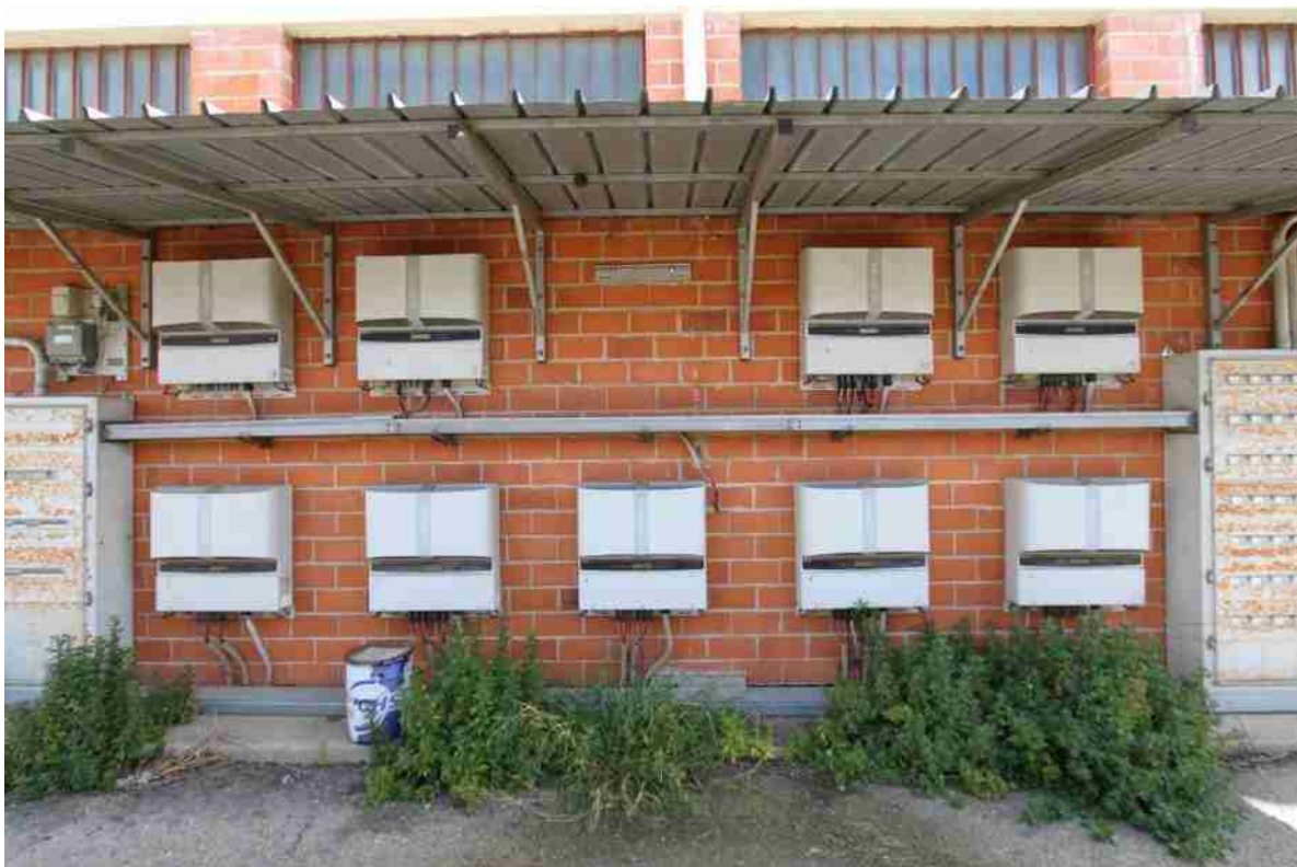
Figura 81_Area Inverter impianto fotovoltaico
