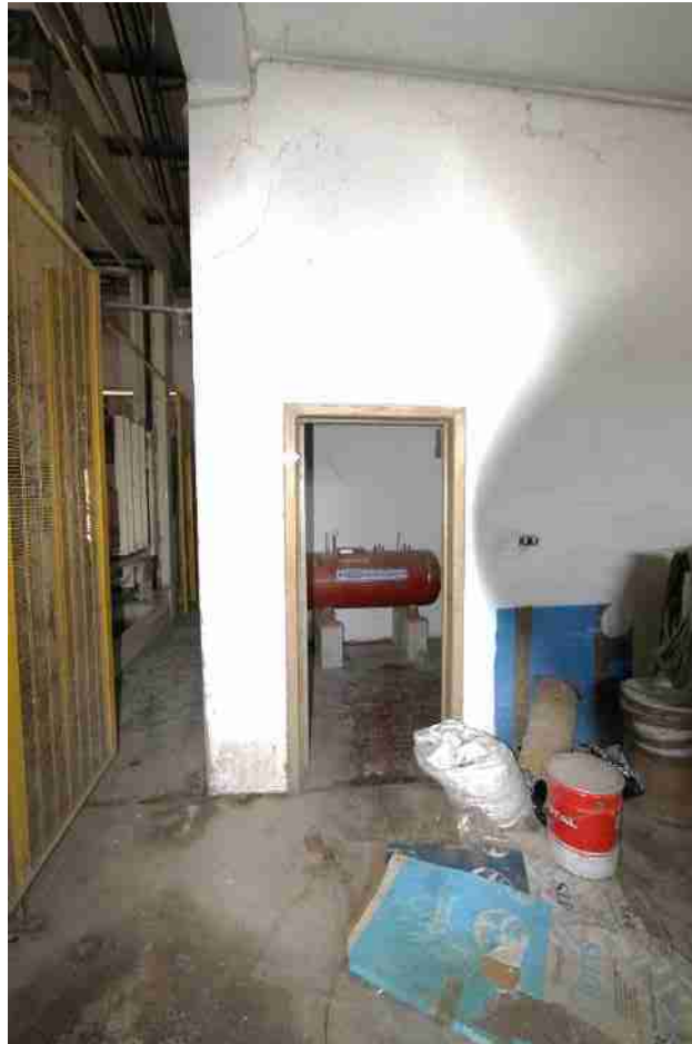
Figura 108_Sala aria compressa
