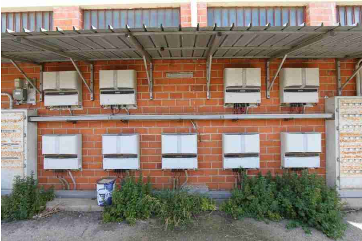
Figura 15_Vista d'insieme degli inverter e dei quadri del 22/03/2024
