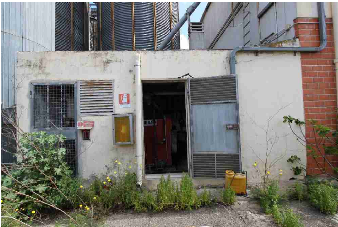
Figura 74_Locale termico caldaia
