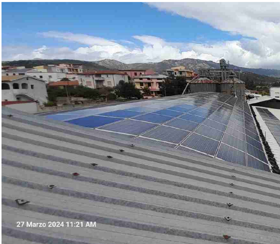
Figura 10_Vista d'insieme dei pannelli fotovoltaici, delle strutture metalliche di supporto
