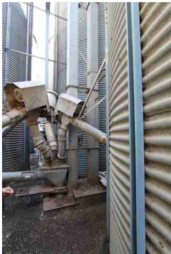
Figura 65_Area Silos: essiccatori
