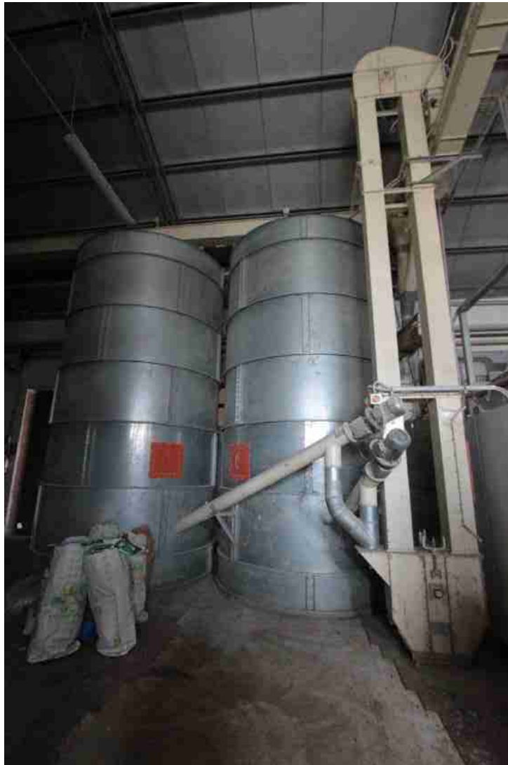
Figura 87_Area Silos interni e sistema di dosaggio
