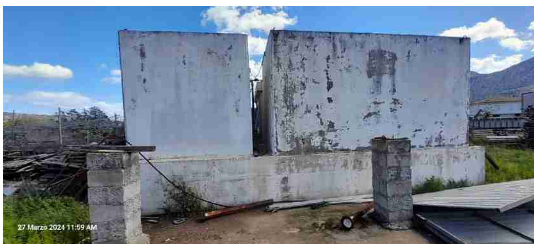
Figura 14_Cisterne antincendio sub.1
