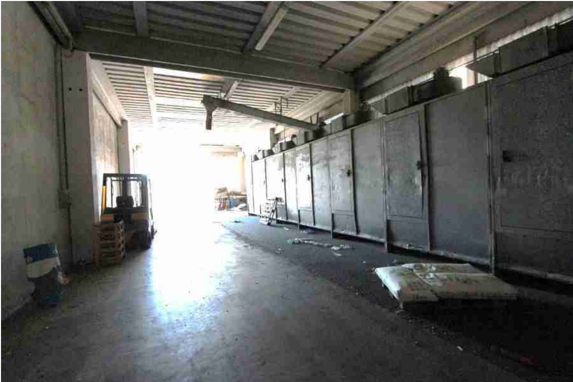
Figura 34_Tramoggia per scarico camion a pavimento, aspiratori e filtri per polveri
