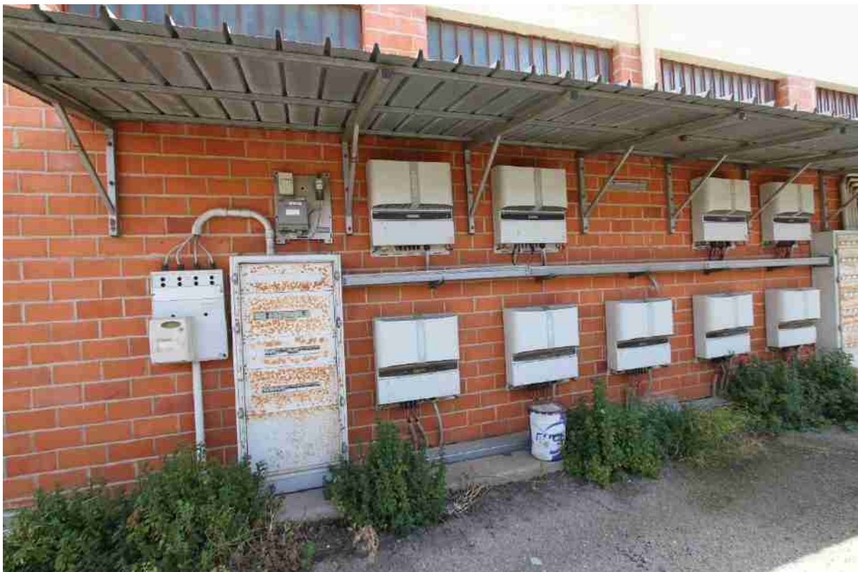
Figura 80_Area Inverter impianto fotovoltaico
