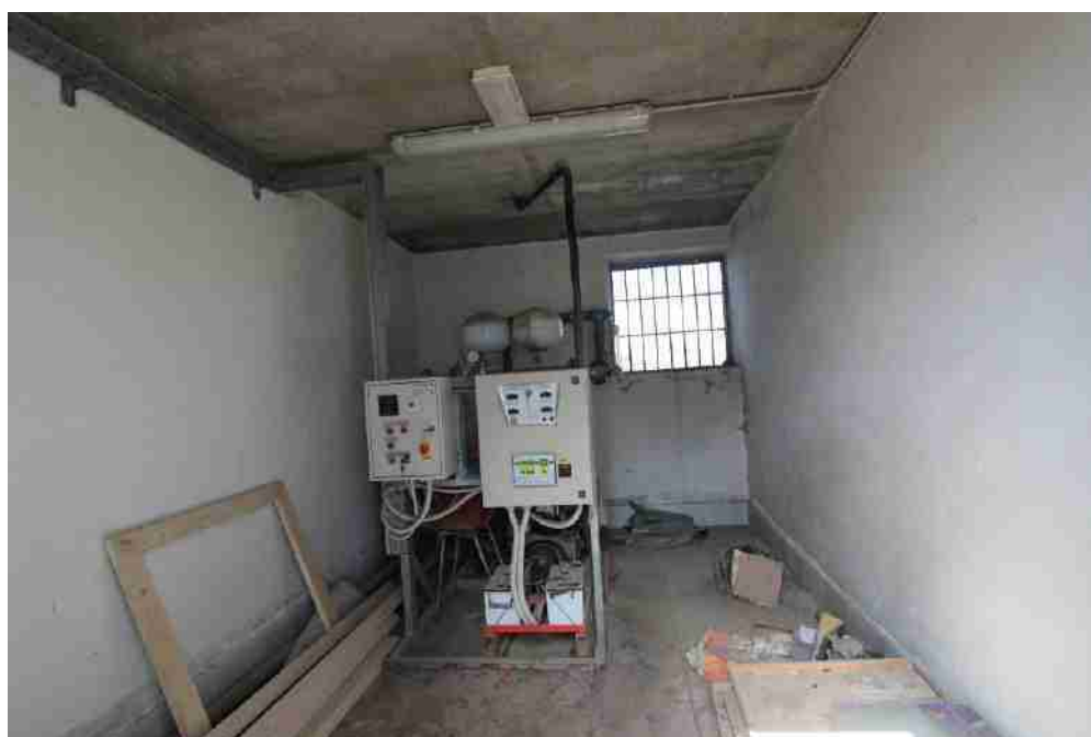
Figura 15_Locale pompe antincendio sub.1
