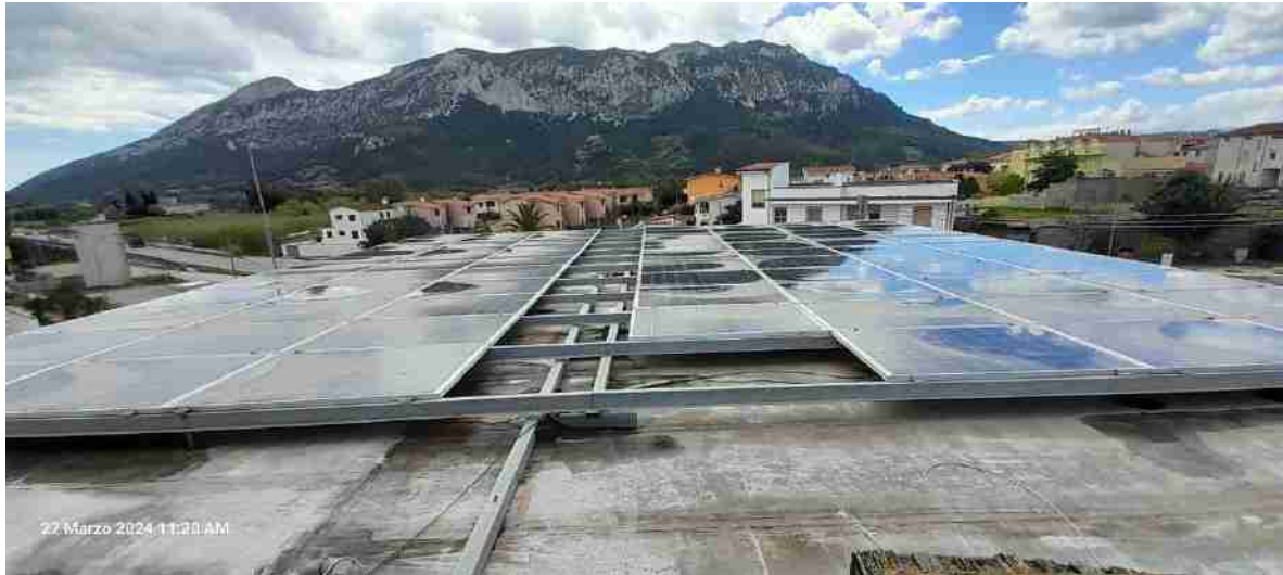
Figura 49_Impianto fotovoltaico sul tetto piano di copertura degli uffici e casa del custode
