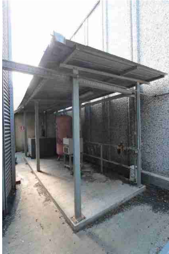
Figura 50_Area compressore ed essicatore
