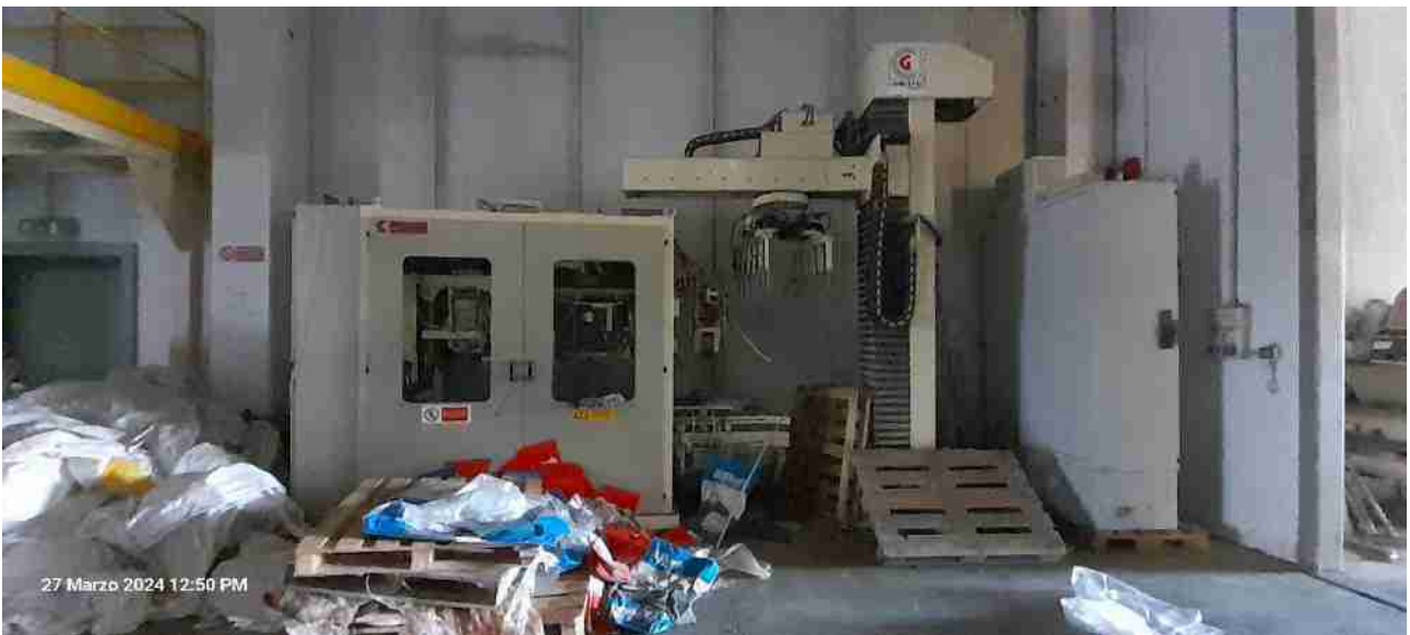
Figura 33_Insacatrice, pallettizzatore con robot e quadro
