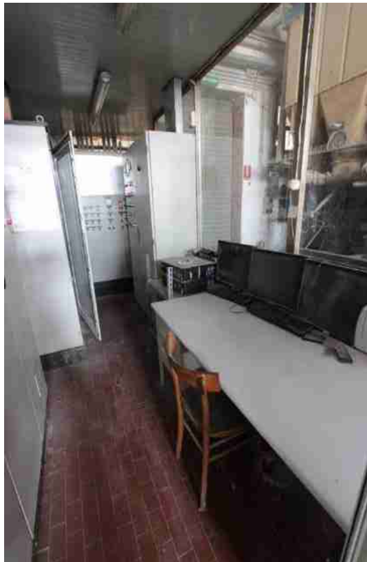
Figura 91_Sala operativa di controllo della produzione
