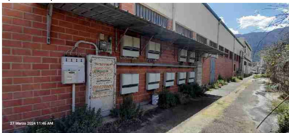
Figura 14_Vista d'insieme degli inverter e dei quadri
