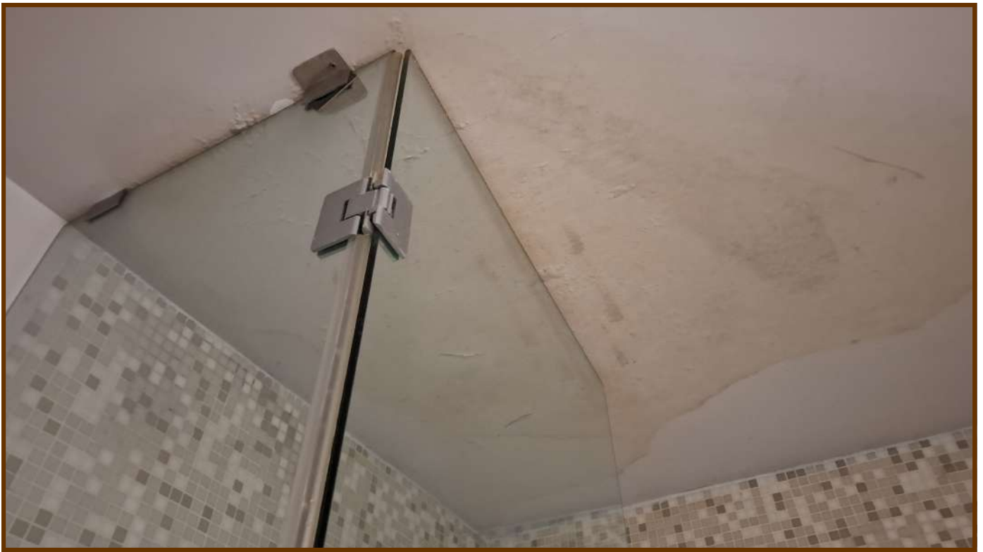
PARTICOLARE PRESENZA UMIDITA' AL PIANO SOTTOSTRADA
