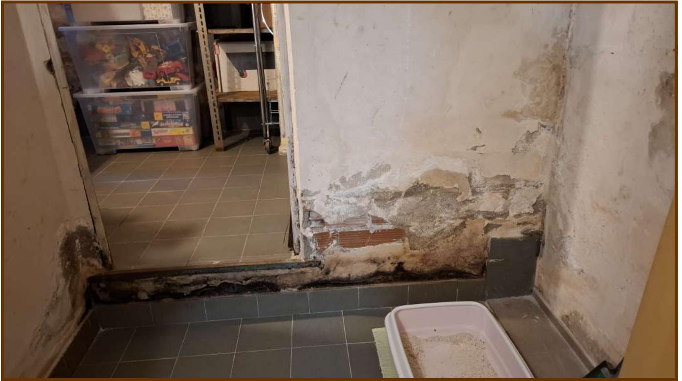
PARTICOLARE PRESENZA UMIDITA' AL PIANO SOTTOSTRADA
