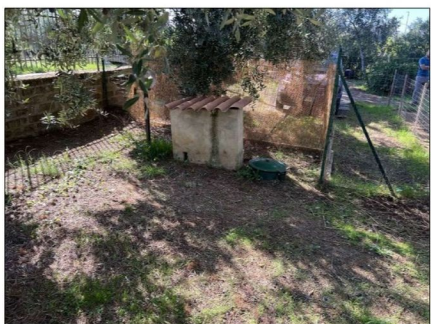
FOTO 2 - serbatoio GPL comune su corte
