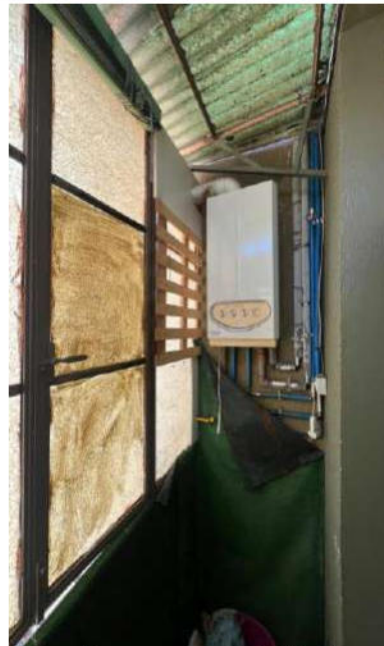
Balcone con chiusura precaria da rimuovere
