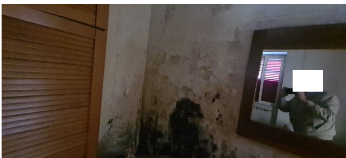
Foto 16 - Macchia infiltrazione da appartamento limitrofo nella Camera 2
