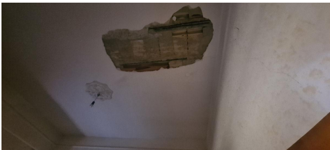
Foto 15 - Distacco dell'intonaco del soffitto nella camera 2
