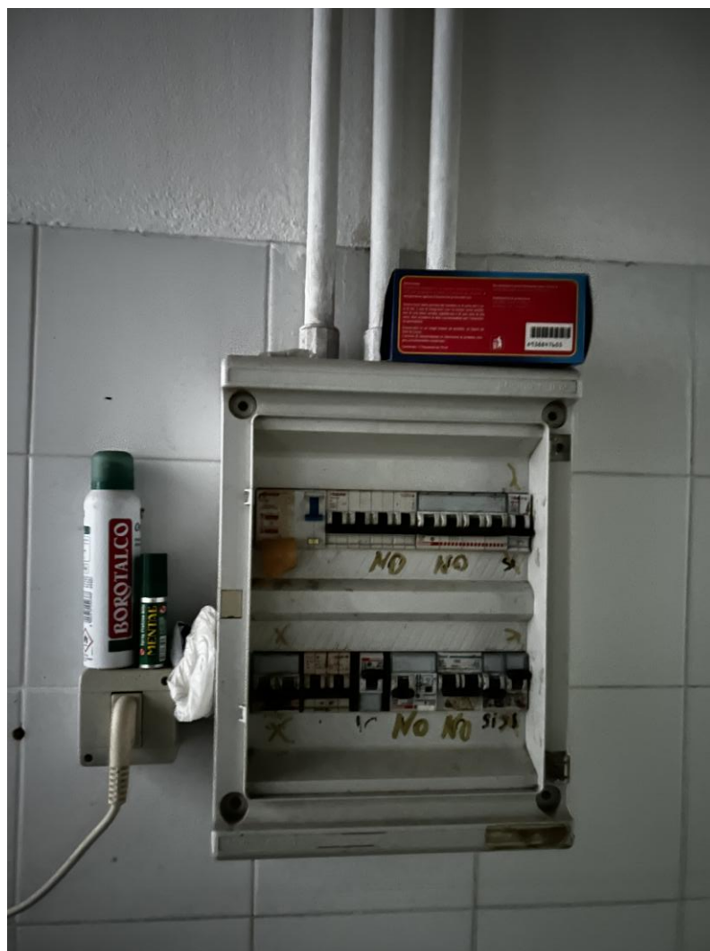
Particolare del quadro elettrico
