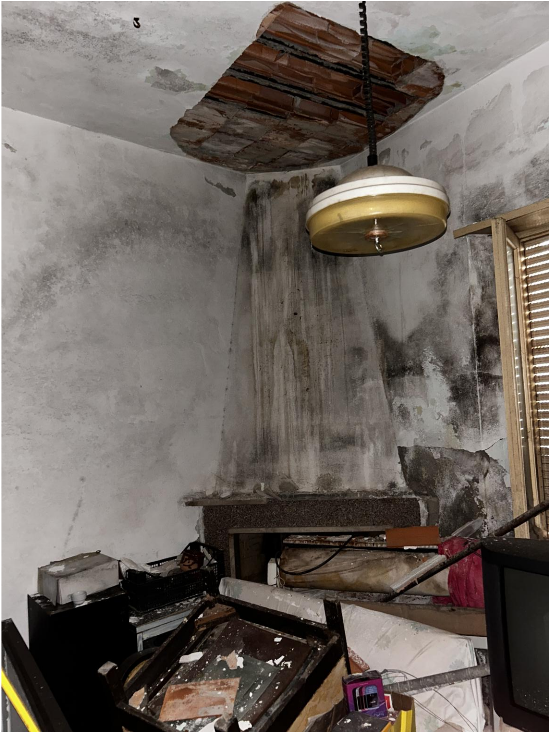
Particolare della situazione del soffitto e dei muri nel soggiorno
