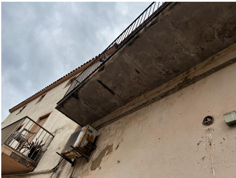
Particolare del terrazzino al Piano primo con evidenti tracce di umidità
