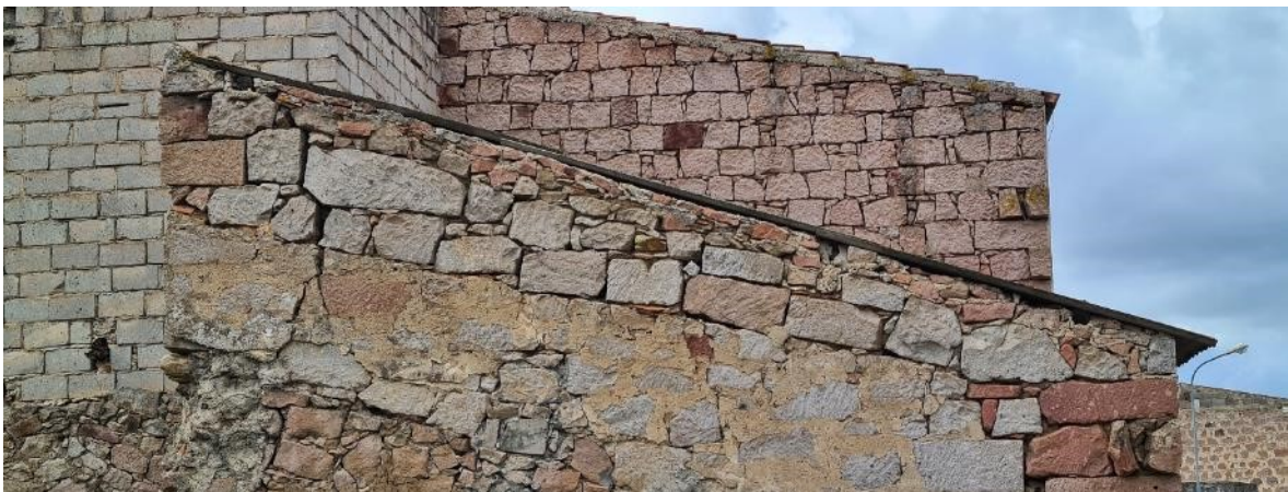
Prospetto laterale – particolare lesione muraria
