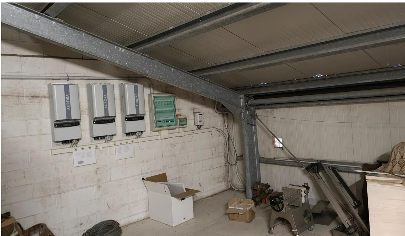
Foto n°38 – Lotto 1 – Comune di San Giorgio della Richinvelda (PN) – Via Pietro Zorutti, 10 – foglio 21 particella 291 – Piano primo – Particolare degli inverter, del quadro elettrico, dei contatori e della centralina dell'impianto fotovoltaico, presenti sulla parete ovest dello stesso deposito.
