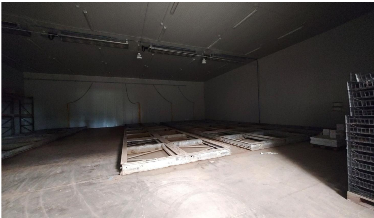
Foto n°70 – Lotto 1 – Comune di San Giorgio della Richinvelda (PN) – foglio 21 particella 372 sub 1 – Veduta interna, da posizione sud, della cella frigo, con particolare delle lampade per l'illuminazione e dell'impianto di refrigerazione.
