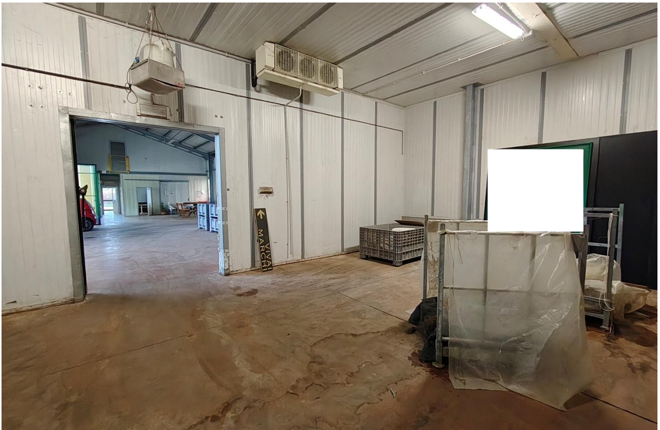
Foto n°50 – Lotto 1 – Comune di San Giorgio della Richinvelda (PN) – foglio 21 particella 291 – Piano terra – Veduta interna di porzione nord-ovest della cella frigo di cui sopra, con particolare dell'impianto di refrigerazione.
