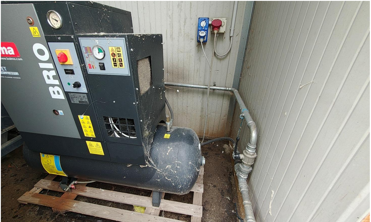
Foto n°13 – Lotto 1 – Comune di San Giorgio della Richinvelda (PN) – foglio 21 particelle 291 – Particolare, da posizione nord, dell'elettrocompressore presente all'interno del vano tecnico.
