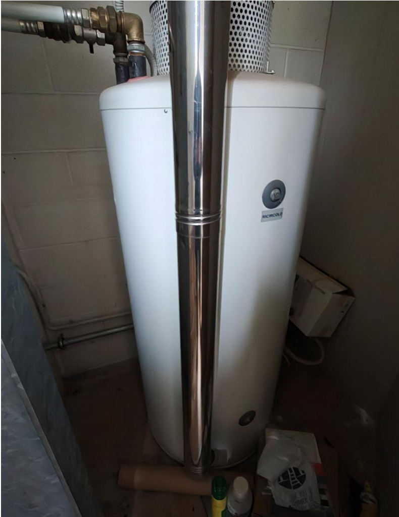
Foto n°21 – Lotto 1 – Comune di San Giorgio della Richinvelda (PN) – Via Pietro Zorutti, 10 – foglio 21 particella 291 – Piano terra – Particolare dello scaldacqua istantaneo a combustione stagna, di cui alla foto precedente, alimentato dal serbatoio per GPL interrato.
