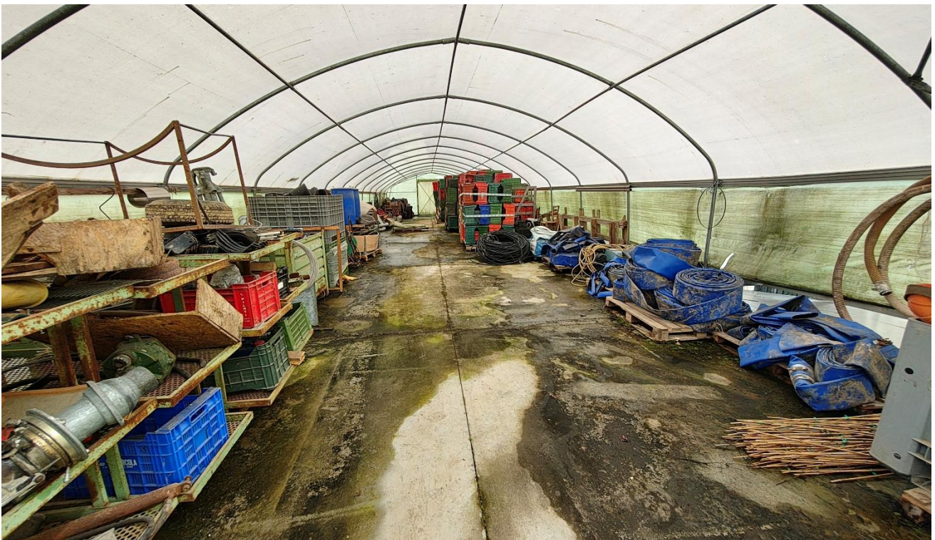
Foto n°58 – Lotto 1 – Comune di San Giorgio della Richinvelda (PN) – Via Pietro Zorutti, 10 – foglio 21 particella 291 – Proseguendo verso est, veduta interna, da posizione sud, del secondo tunnel freddo.
