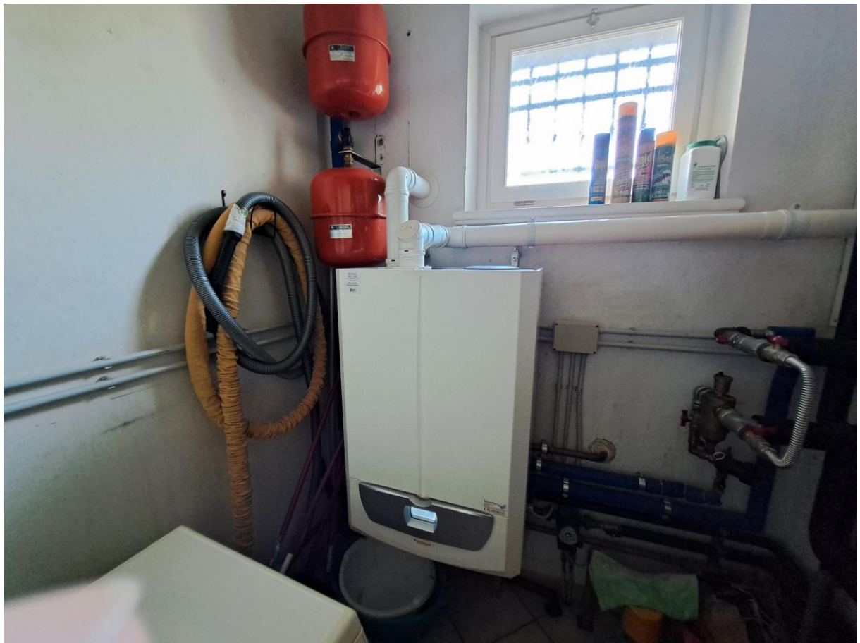
Foto n° 23 – Lotto 1 - Comune di S. Giorgio della Richinvelda (PN) – Frazione Rauscedo - Foglio 21 m.le 375 sub 1 – Particolare di porzione ovest della centrale termica posta al piano terra.
