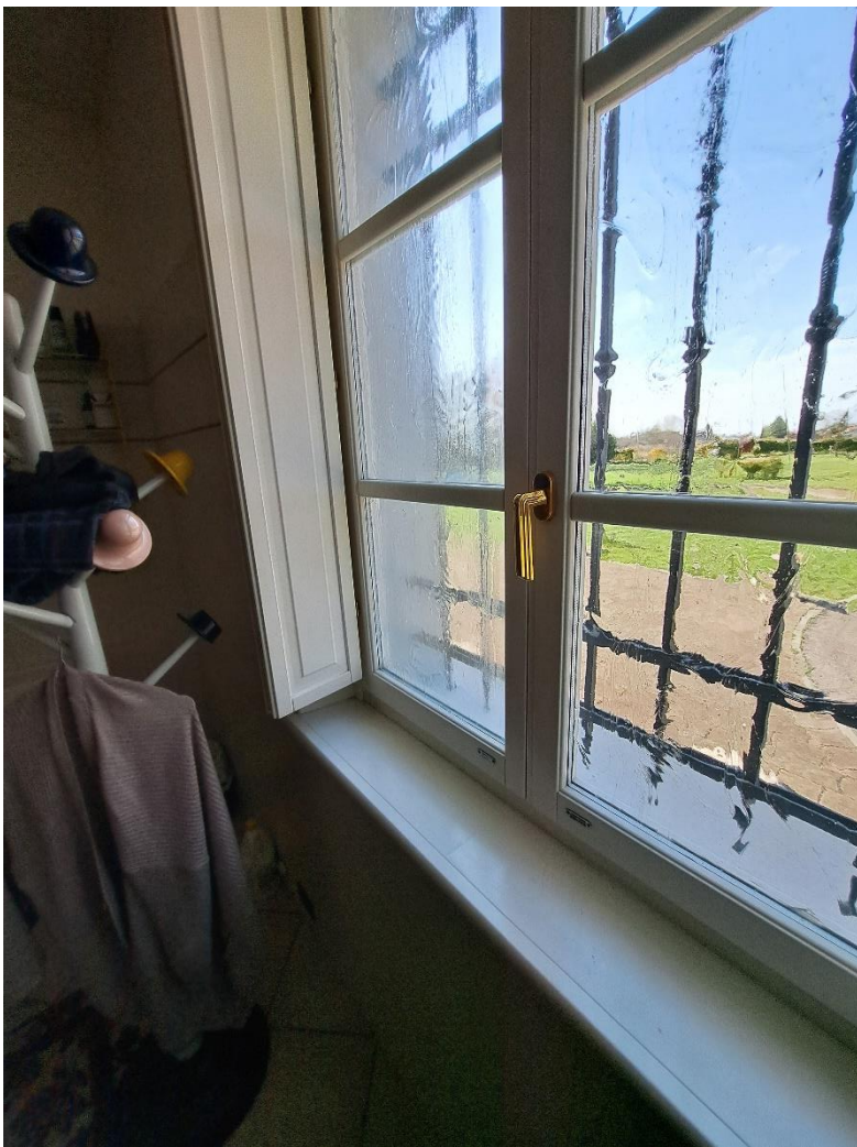
Foto n° 43 – Lotto 1 - Comune di S. Giorgio della Richinvelda (PN) – Frazione Rauscedo - Foglio 21 m.le 375 sub 2 – Particolare dei serramenti del bagno al piano terra. Tutte le finestre del piano terra sono dotate di inferriate.
