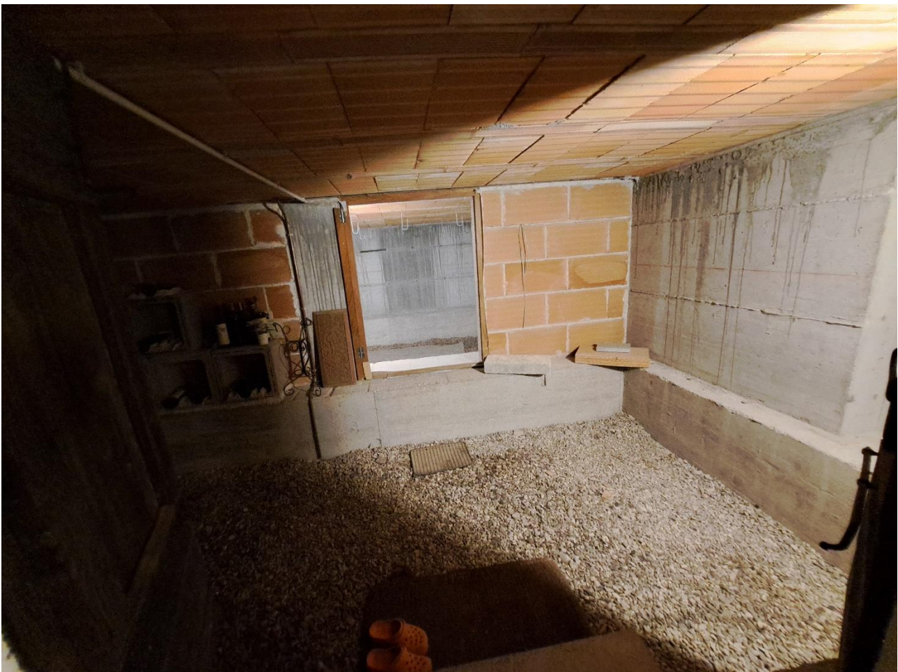
Foto n° 50 – Lotto 1 - Comune di S. Giorgio della Richinvelda (PN) – Frazione Rauscedo - Foglio 21 m.le 375 sub 2 – Piano interrato - Veduta di uno dei vani strutturali tombati al di sotto del piano terra sull'intera superficie dell'edificio, esclusa quella occupata dalla cantina.
