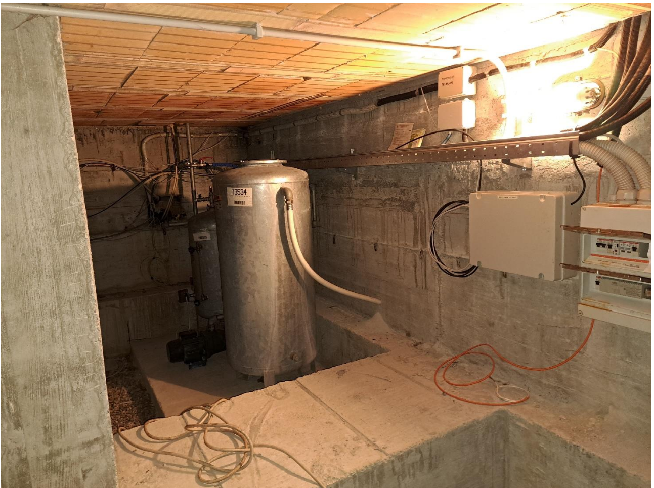
Foto n° 52 – Lotto 1 - Comune di S. Giorgio della Richinvelda (PN) – Frazione Rauscedo - Foglio 21 m.le 375 sub 2 – Particolare delle autoclavi e di una parte dei quadri elettrici al servizio del fabbricato, presenti in uno dei vani nell'interrato.
