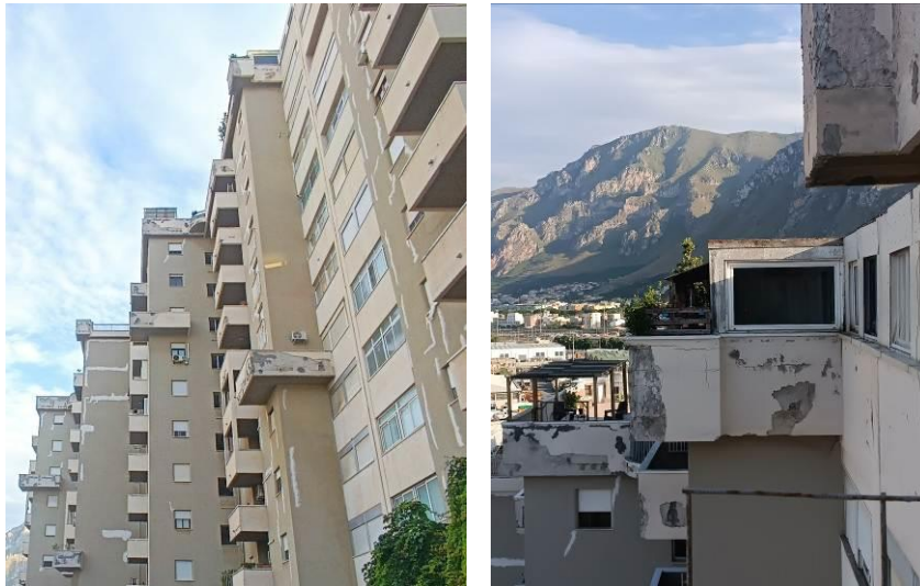
Figg. 11, 12 Particolare dei degradi.
