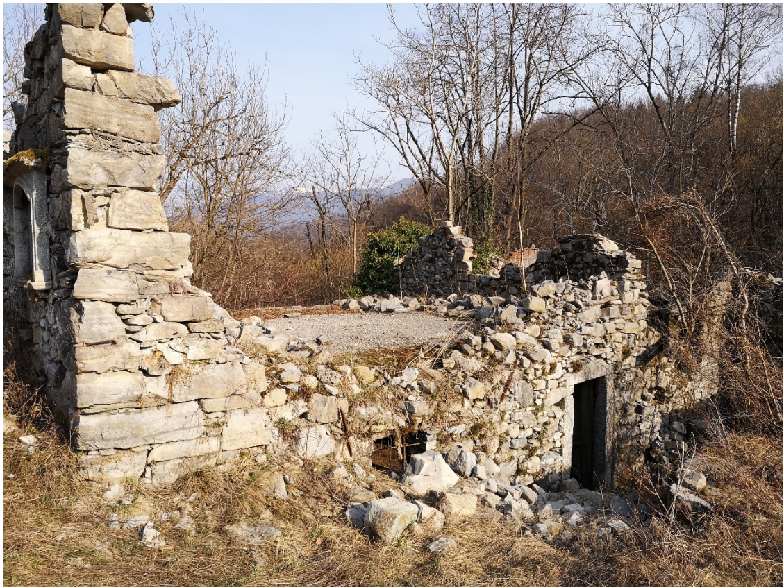
Foto 4 – Fabbricato rurale fatiscente
