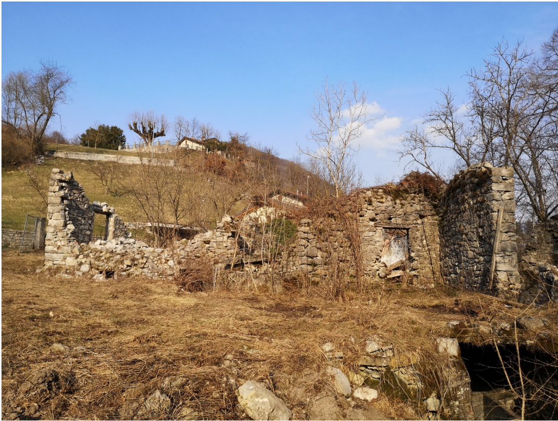
Foto 5 – Fabbricato rurale fatiscente
