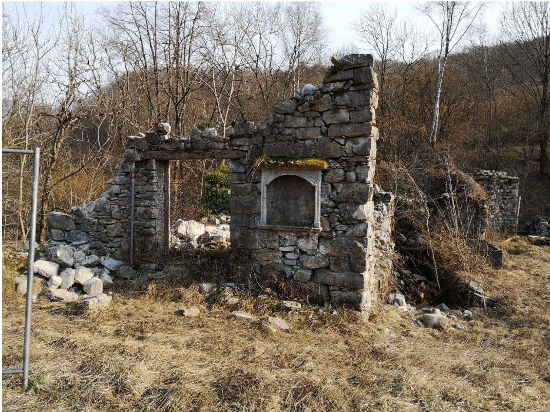
Foto 3 – Fabbricato rurale fatiscente
