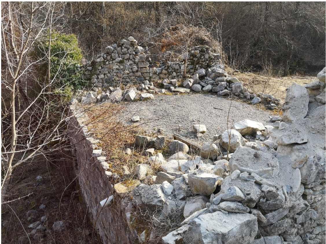
Foto 6 – Fabbricato rurale fatiscente
