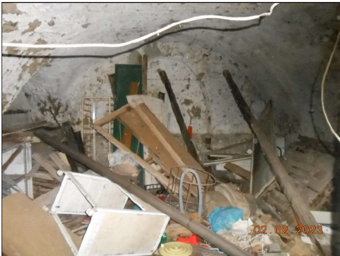
FOTO N. 14 Vista interna del piano interrato. Si notano rifiuti vari.
