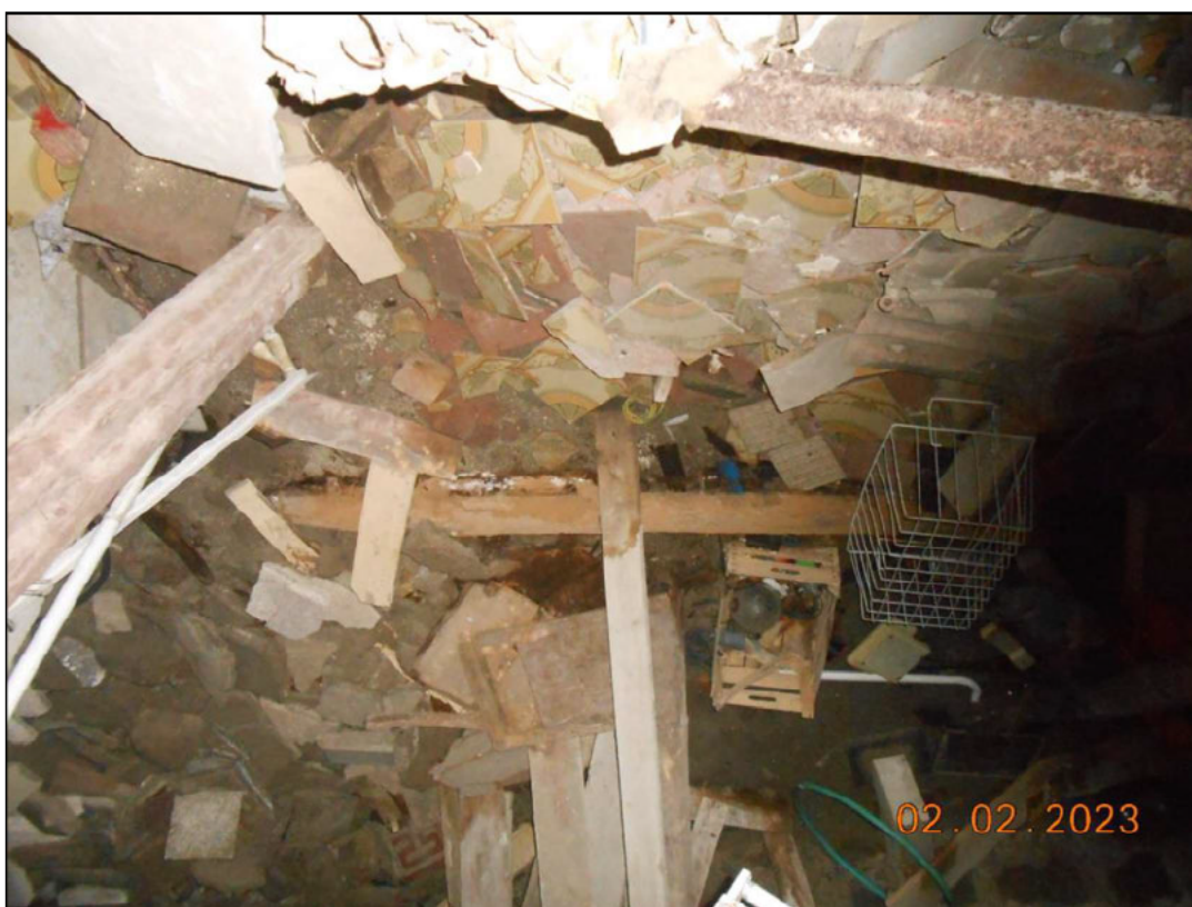
FOTO N. 16 Vista del locale interrato, pieno di rifiuti misti dei lavori di demolizione.
