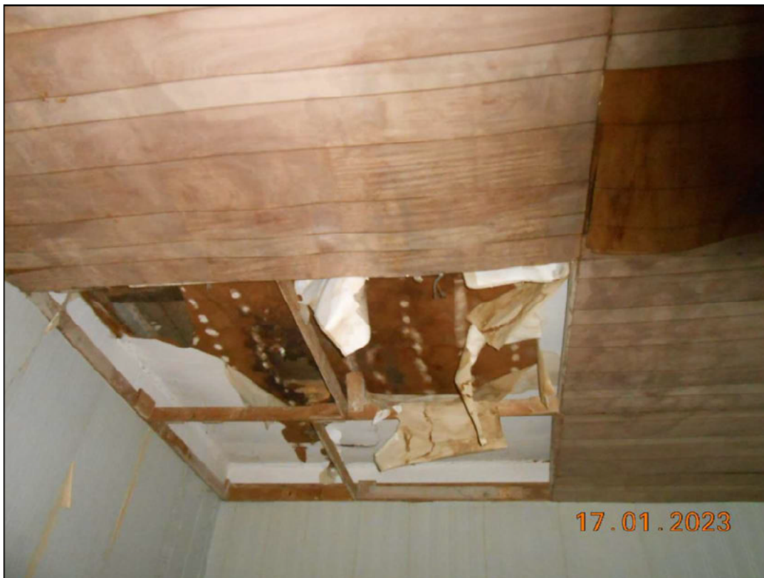
FOTO N. 41 Vista interna del piano primo. Si nota la controsoffittatura dei solai e le diffuse infiltrazioni.
