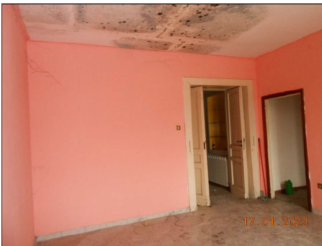
FOTO N. 42 Vista interna del piano primo. Si notano le diffuse infiltrazioni d'acqua sul soffitto
