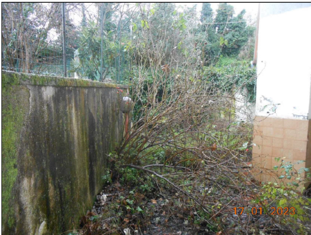
FOTO N. 34 Vista della corte pertinenziale p.lla 421. Si nota lo stato di degrado.
