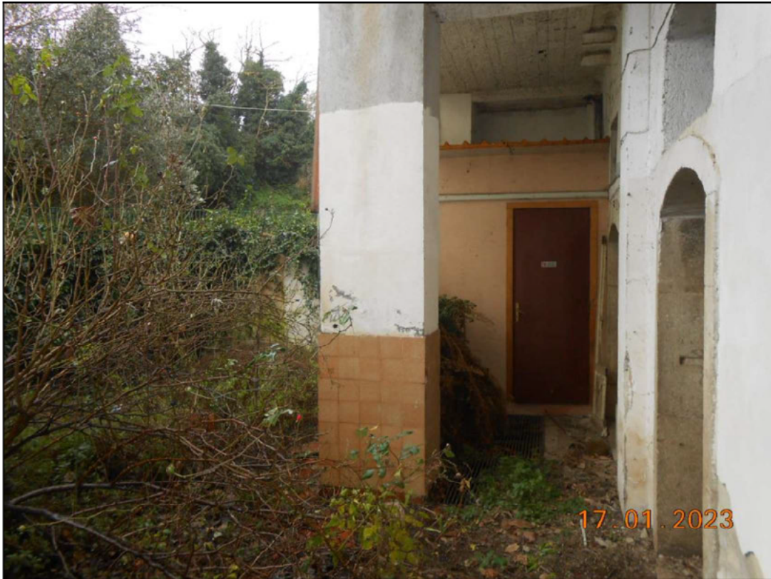
FOTO N. 35 Vista del portico e w.c. a piano terra, adiacente alla corte p.IIa 421. Si nota il degrado.
