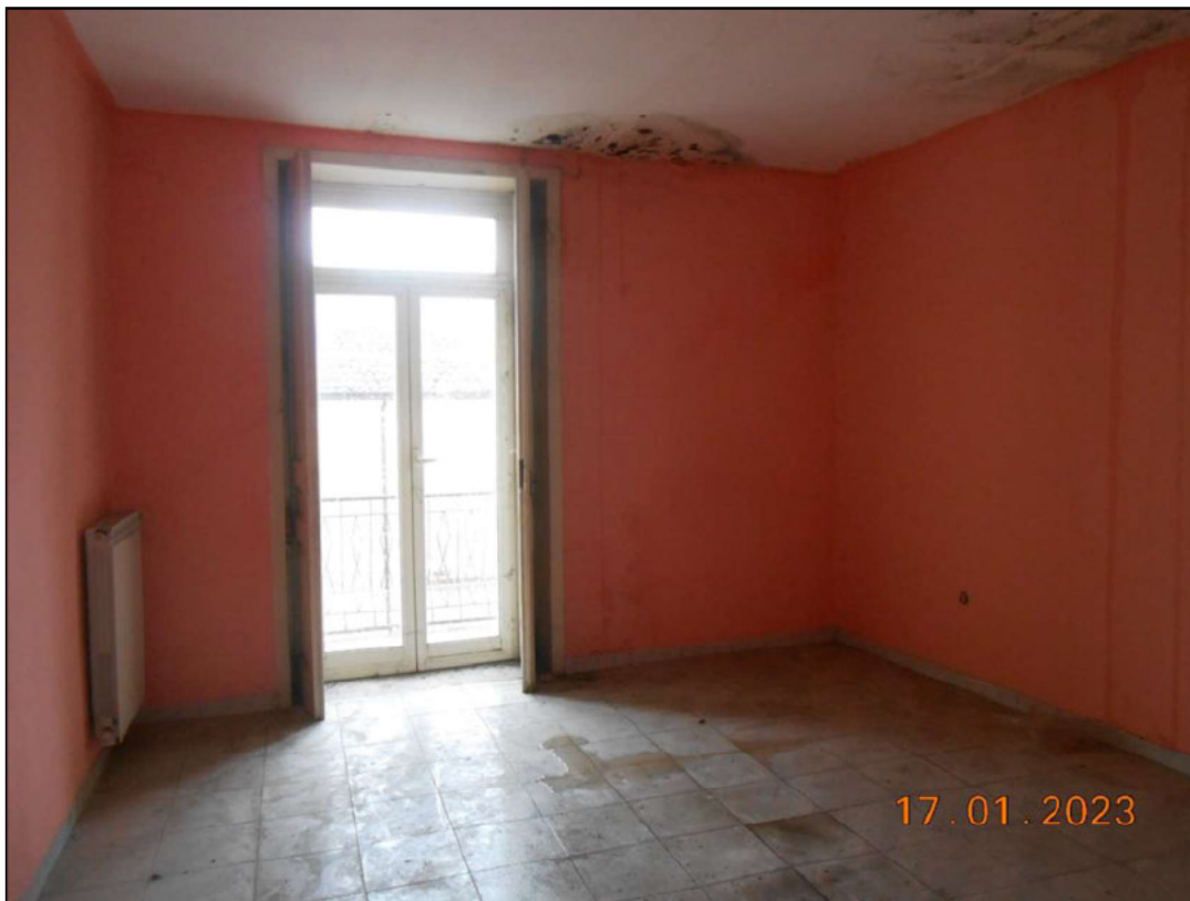
FOTO N. 43 Vista interna del piano primo. Si notano diffuse infiltrazioni sul soffitto e l'acqua sul pavimento
