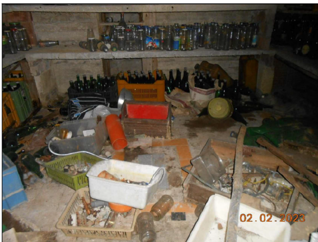
FOTO N. 12 Vista interna del piano interrato dell'immobile pignorato. Si notano rifiuti di ogni genere.
