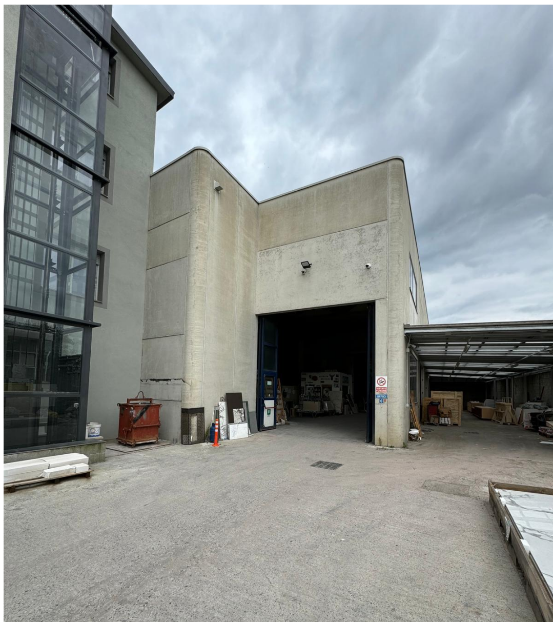
Veduta dell'ingresso in lato sud-est (accesso che avviene ad oggi da proprietà di terzi senza alcuna servitù trascritta né accordo scritto) Sulla destra si noti la tettoia realizzata sull'area di proprietà esclusiva in assenza di titolo edilizio
