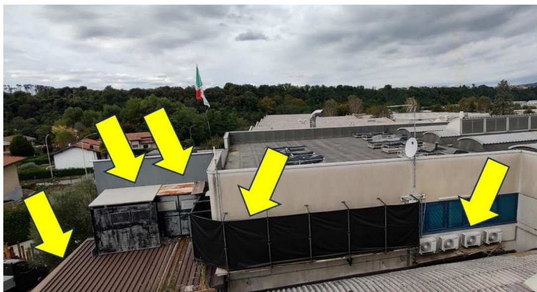
Veduta del ballatoio esterno (realizzato senza titolo) e delle motocondensanti dell'impianto ad espansione diretta appese su proprietà di terzi dei baraccamenti esterni realizzati sempre senza titolo.
