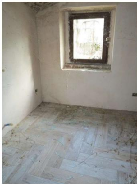
danneggiamenti e rottura vetri
