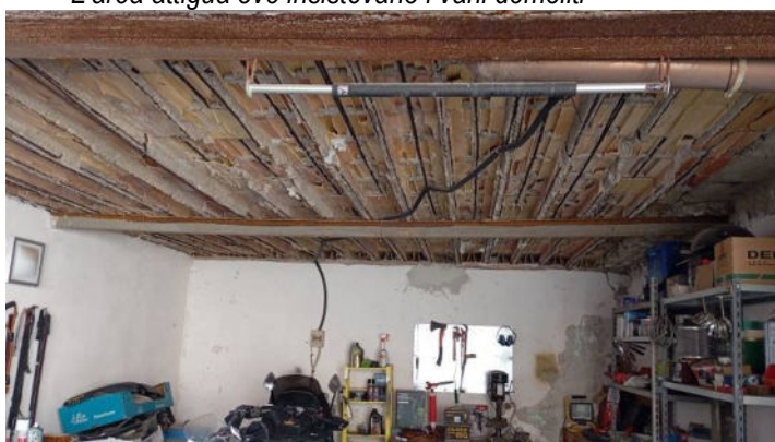
Particolare dello stato di degrado del solaio
