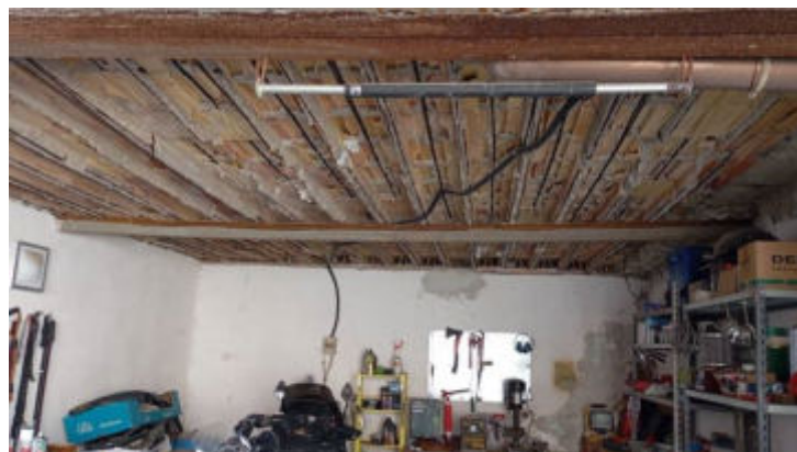
Particolare dello stato di degrado del solaio
