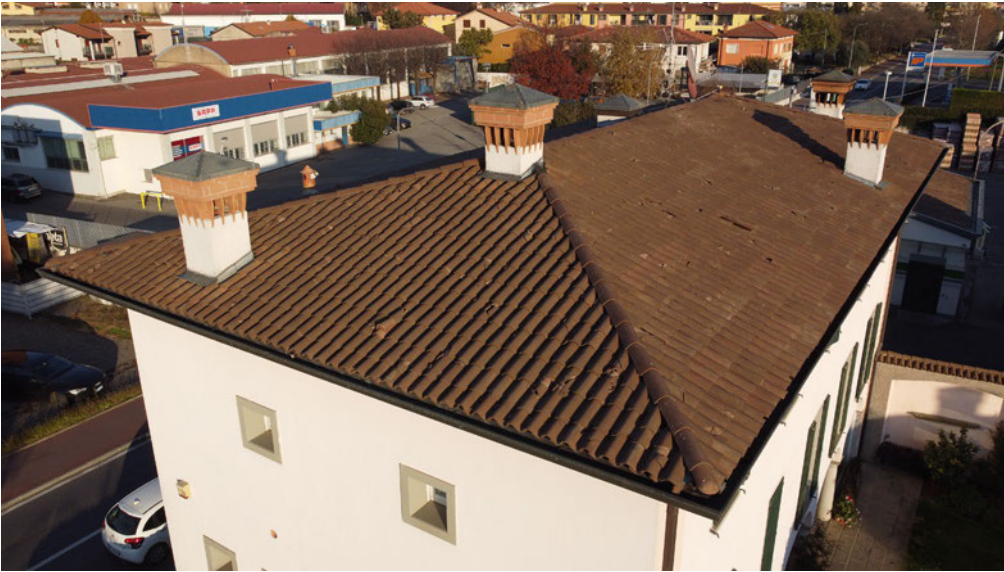
Vista della copertura con danni ai coppi
