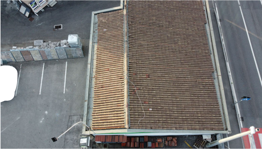
Vista della copertura esposizione con danni ai coppi
