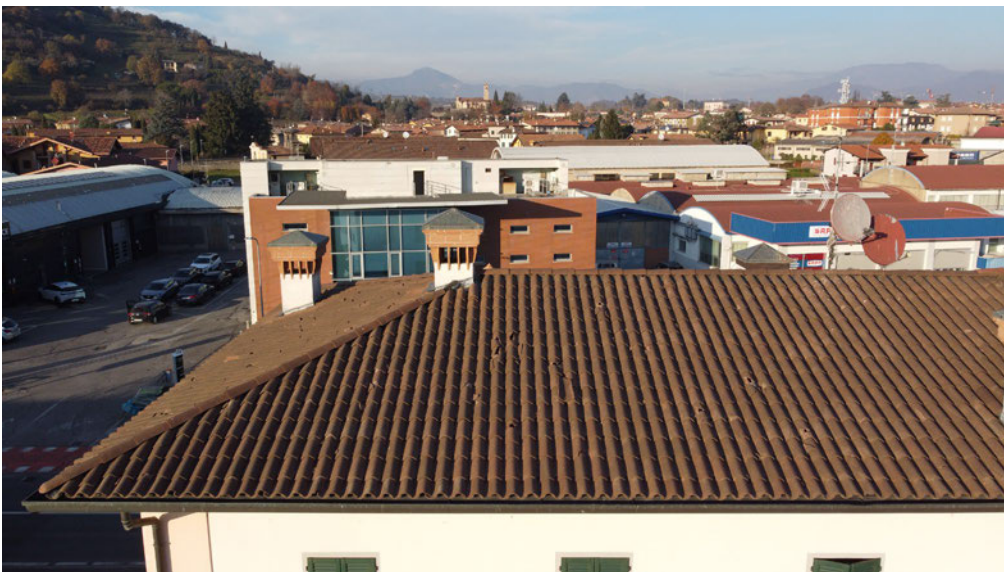
Vista della copertura con danni ai coppi
