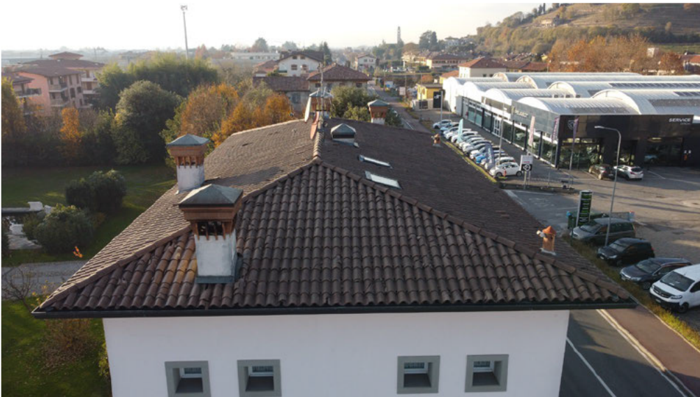
Vista della copertura con danni ai coppi
