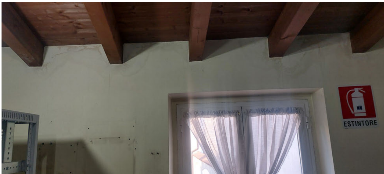
Vista dell'infiltrazione localizzata n. 2 uffici
