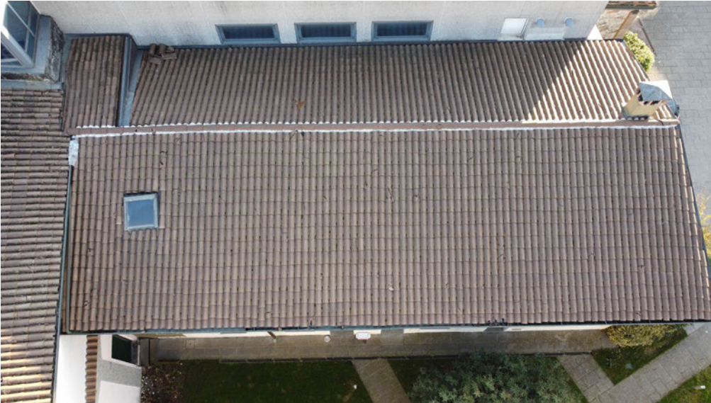
Vista della copertura uffici/sala riunioni con danni ai coppi
