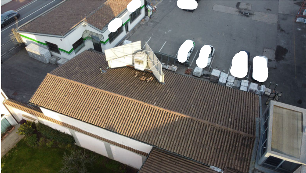
Vista della copertura uffici centrali con danni ai coppi
