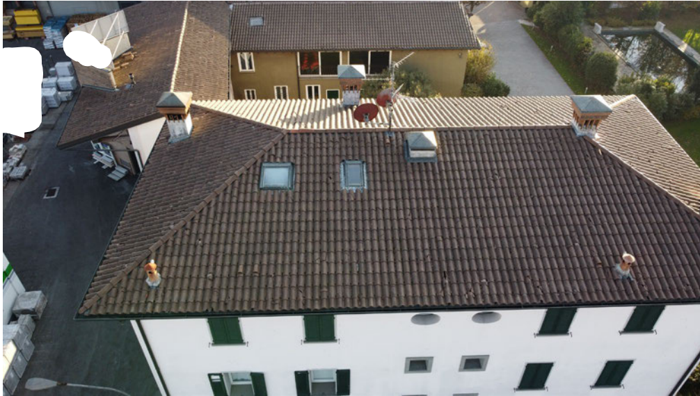
Vista della copertura con danni ai coppi
