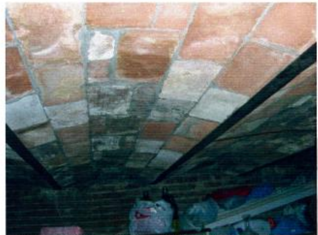
SOLINO INVOLINE IN LATERIZIO IN CORRISPONDENZA DELLA TERRAZZA CONDOMINIALE.
