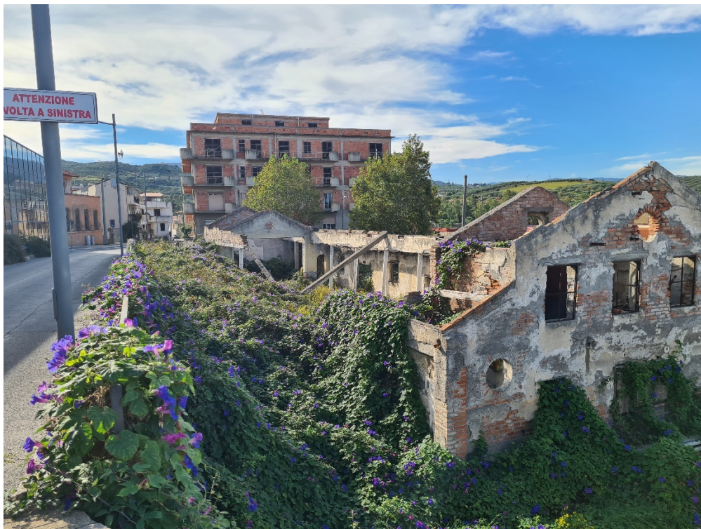
Foto n.004 - Immobile fatiscente e terreni circostanti
