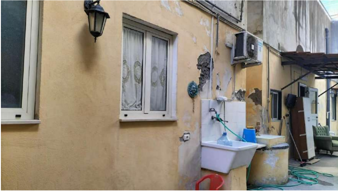
Androne comune scoperto_ stato manutentivo prospetto p.t.
