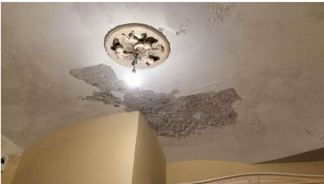
Particolare soffitto Camera 1
