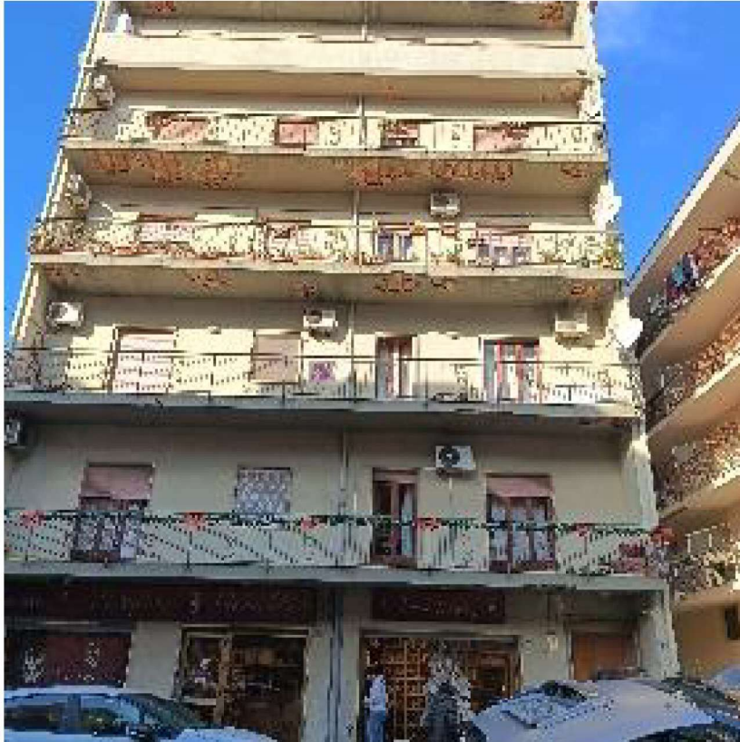
PROSPETTO FABBRICATO CON EVIDENTI PARTI AMMALORATE in particolare sottobalconi
