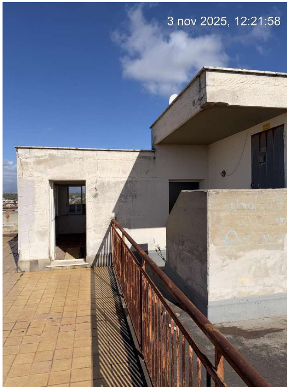
FOTO 32 – LOCALE DEPOSITO + TERRAZZO SUB. 39
