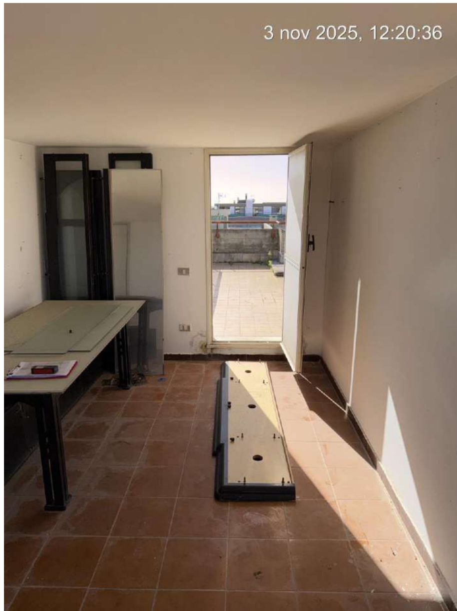
FOTO 25 – LOCALE DEPOSITO + TERRAZZO SUB. 39
