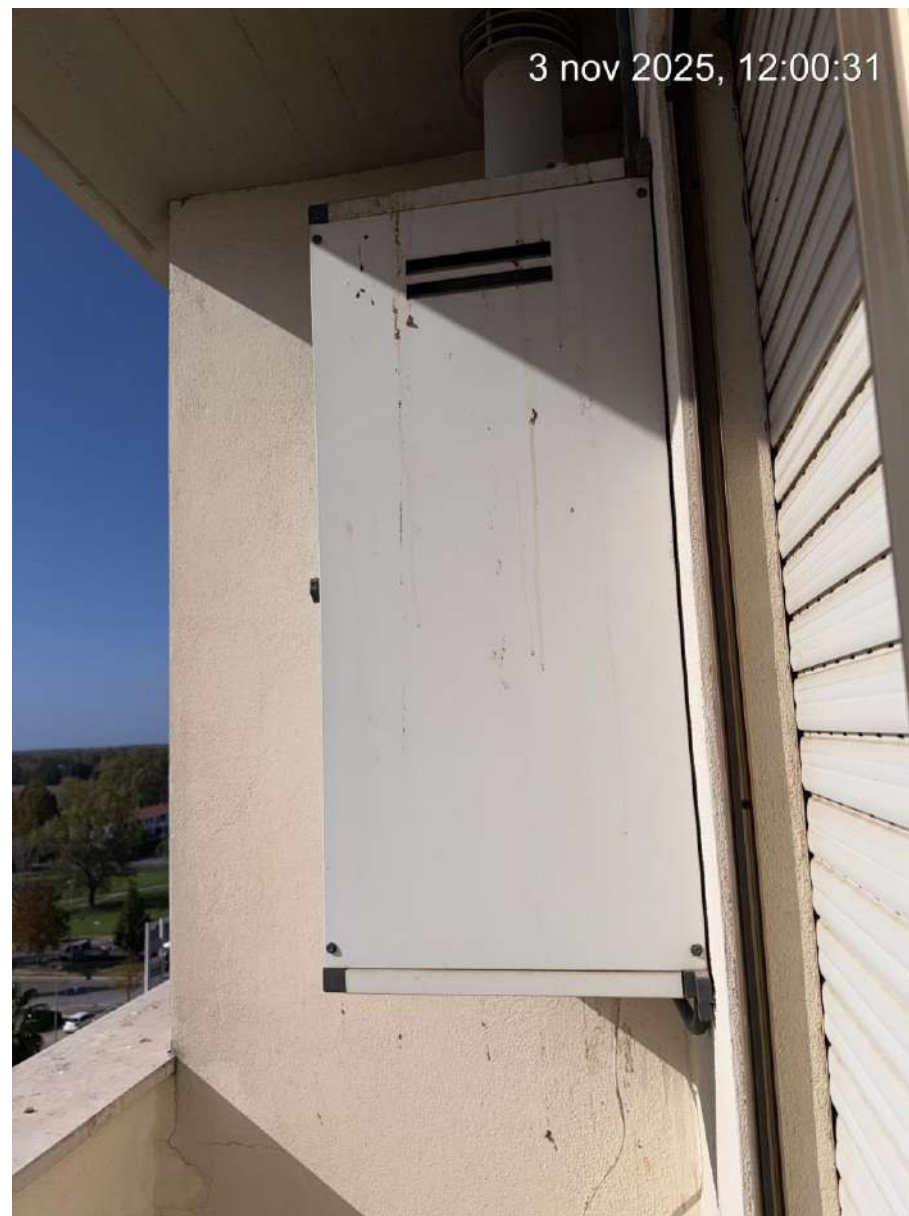
FOTO 10 – CALDAIA ESTERNA (APPARTAMENTO SUB. 37)
