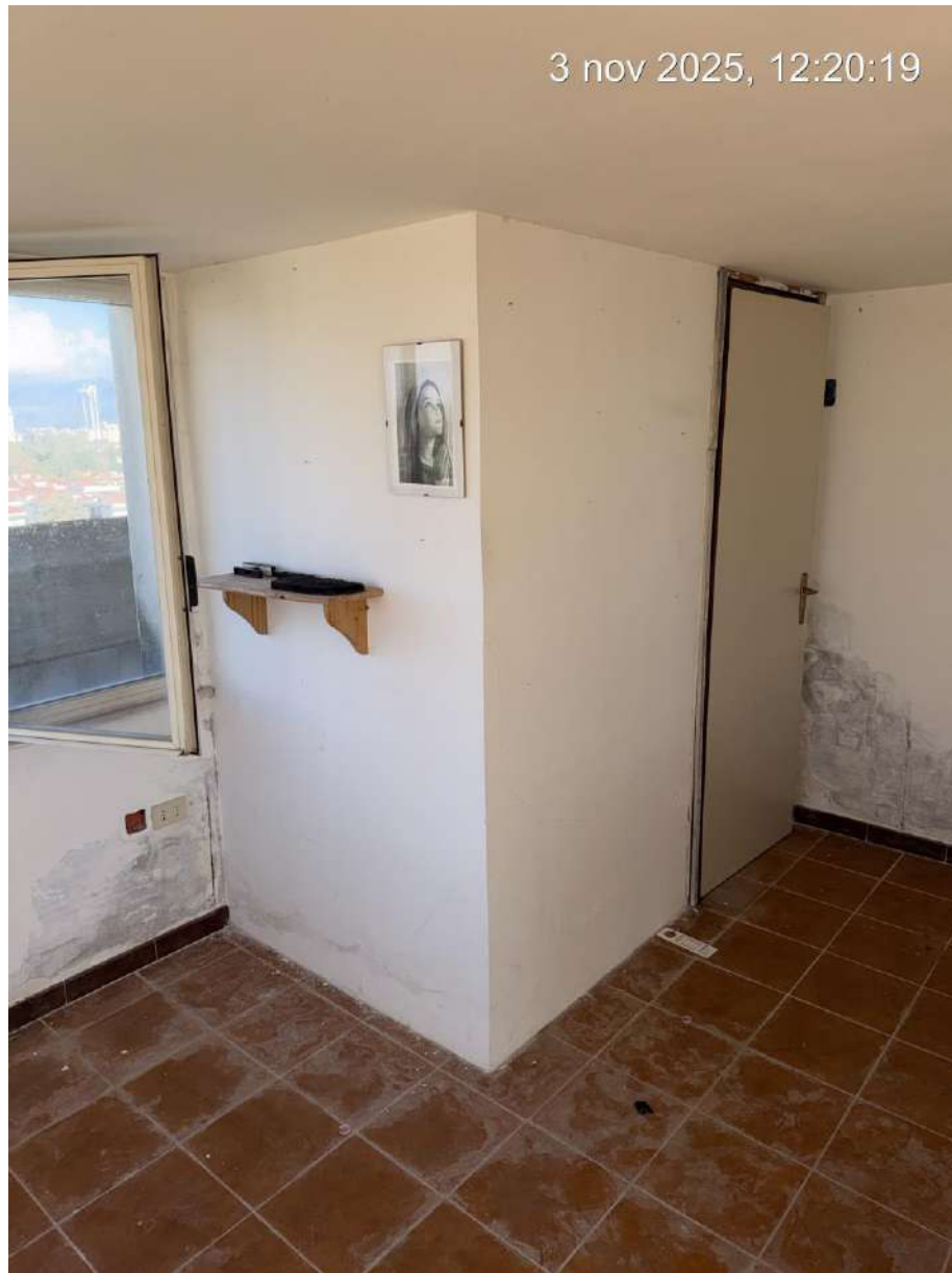
FOTO 23 – LOCALE DEPOSITO + TERRAZZO SUB. 39
