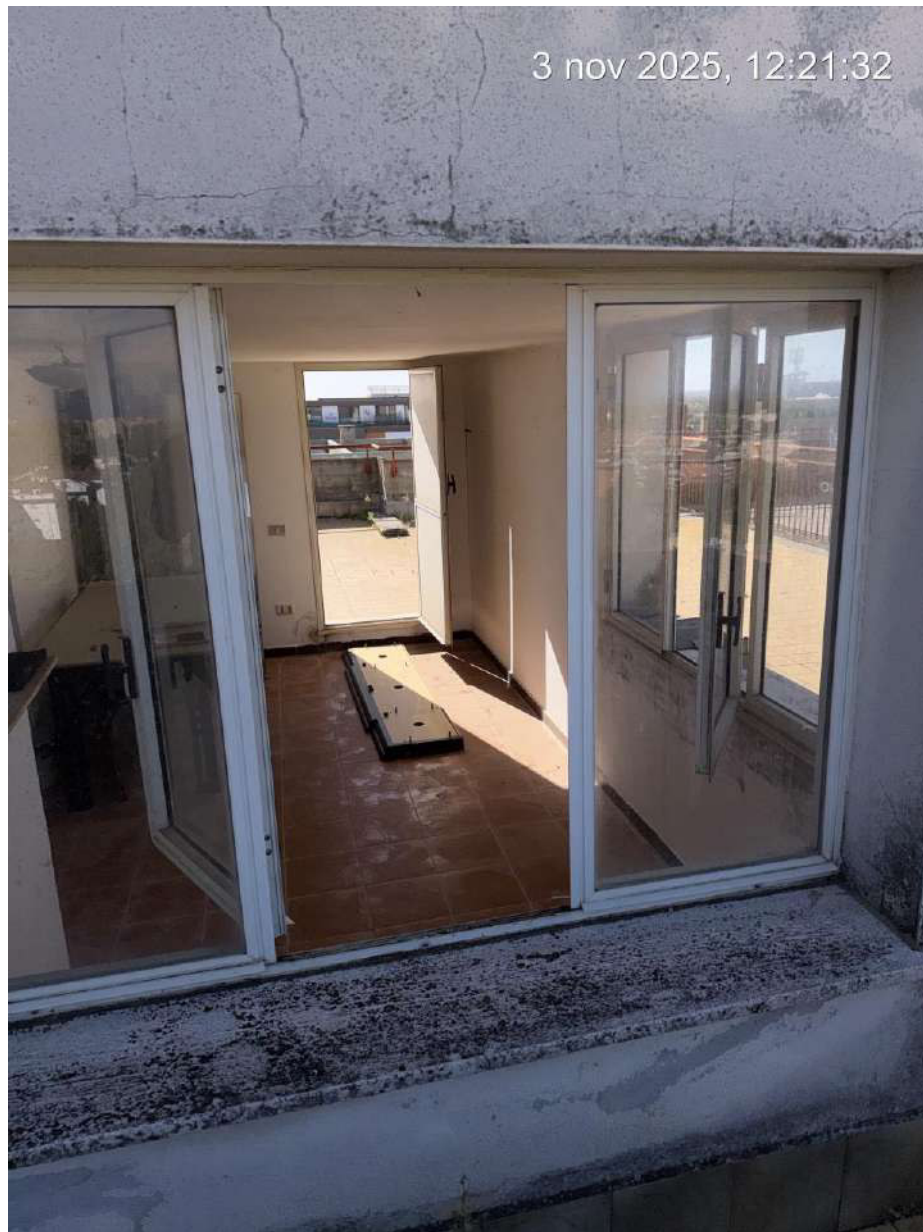
FOTO 31 – LOCALE DEPOSITO + TERRAZZO SUB. 39
