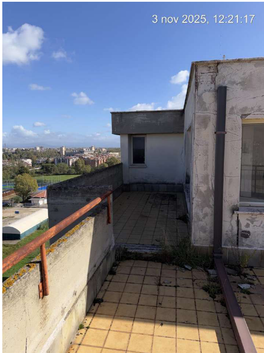
FOTO 29 – LOCALE DEPOSITO + TERRAZZO SUB. 39
