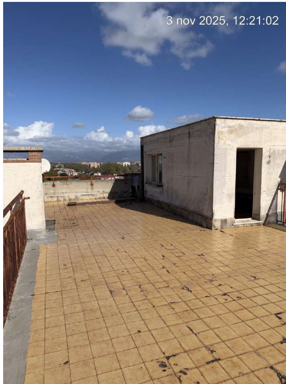
FOTO 28 – LOCALE DEPOSITO + TERRAZZO SUB. 39
