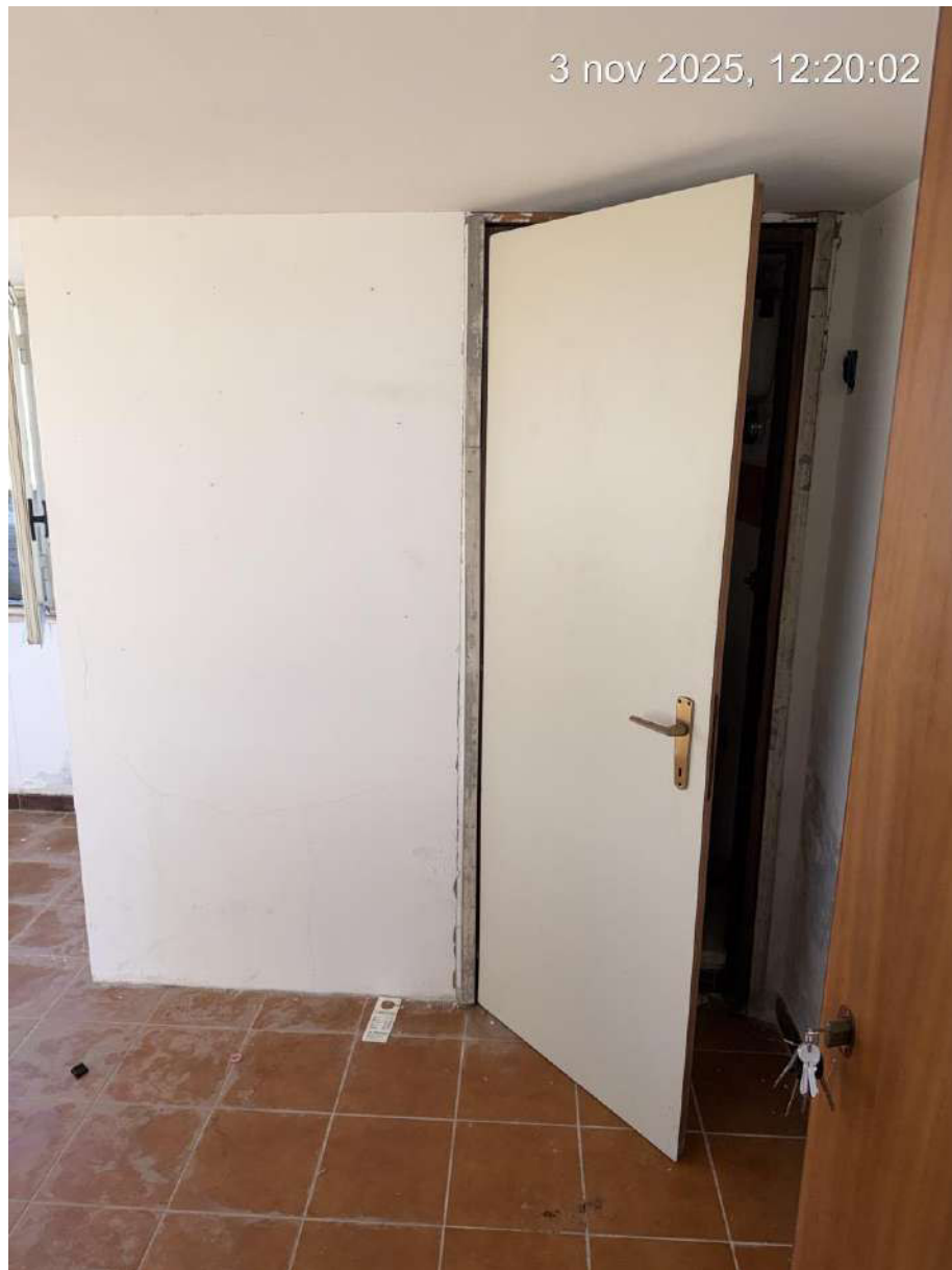
FOTO 21 – LOCALE DEPOSITO + TERRAZZO SUB. 39
