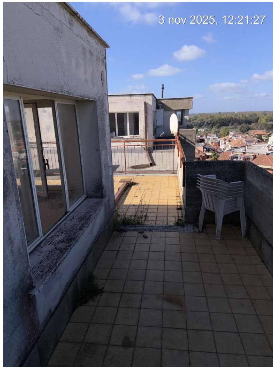
FOTO 30 – LOCALE DEPOSITO + TERRAZZO SUB. 39
