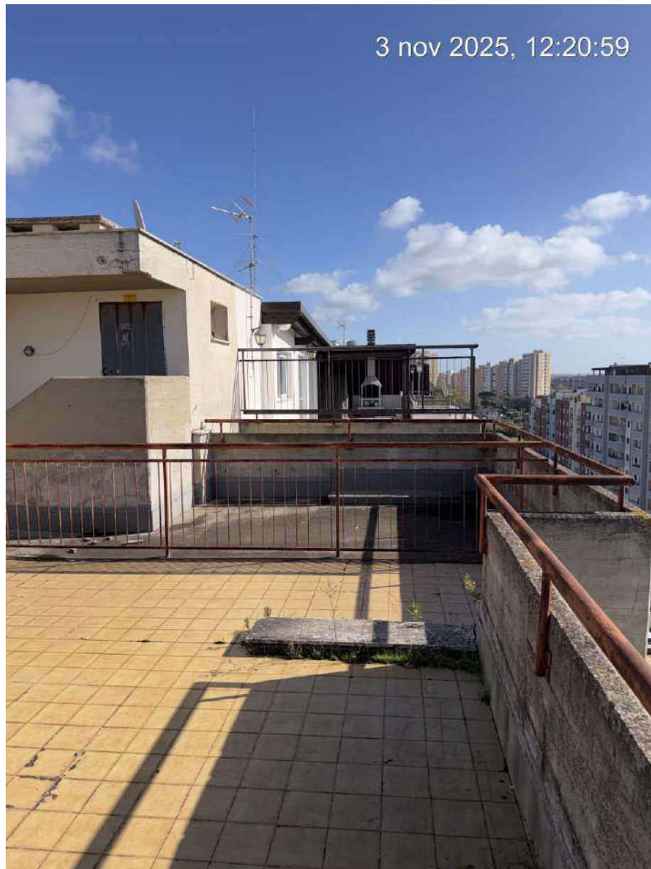
FOTO 27 – LOCALE DEPOSITO + TERRAZZO SUB. 39
