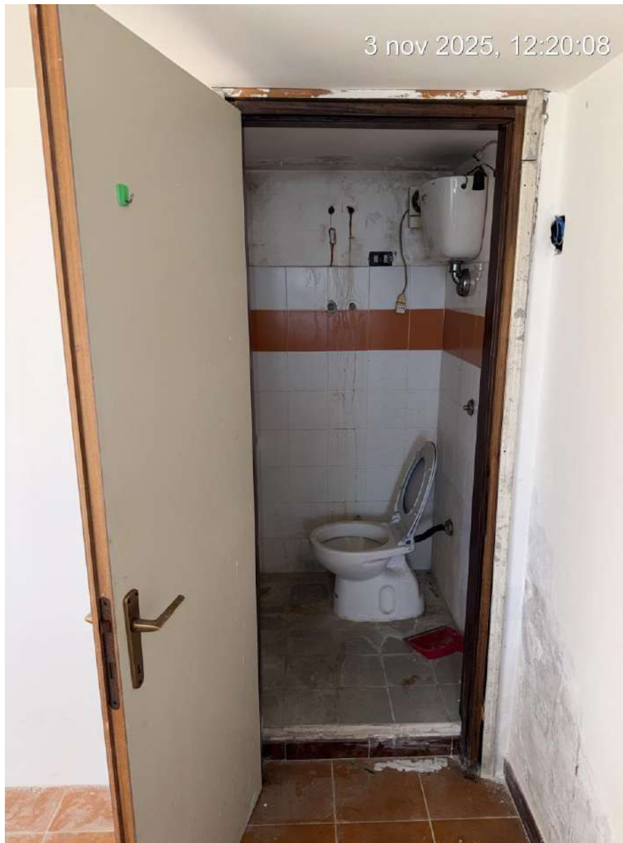
FOTO 22 – LOCALE DEPOSITO + TERRAZZO SUB. 39
