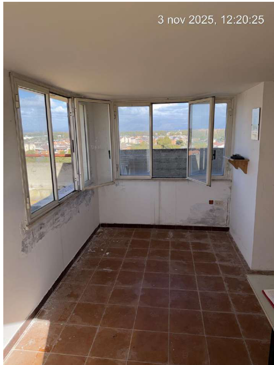
FOTO 24 – LOCALE DEPOSITO + TERRAZZO SUB. 39
