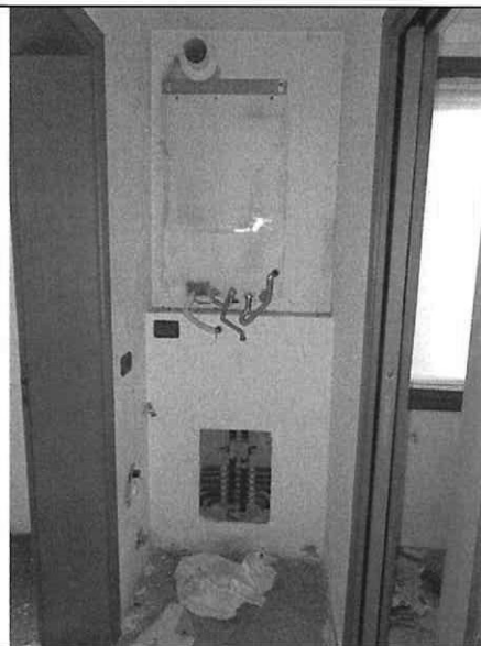
Foto n°15: Antibagno con vestigia della caldaia asportata
