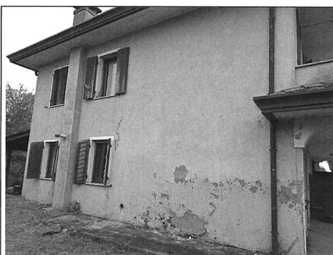
Foto n°8: Dettaglio del degrado del prospetto ovest
