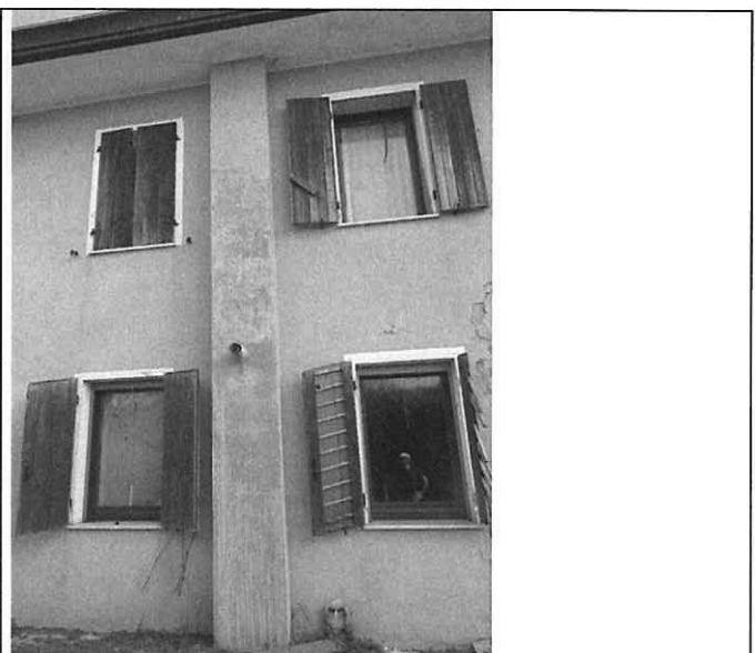
Foto n°34: Dettaglio del degrado degli scuri ad ovest
