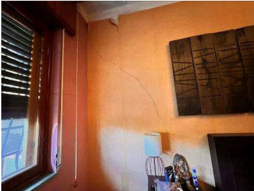
LOTTO 1 – CORPO B - Vista interna camera da letto – particolare cavillatura su parete
