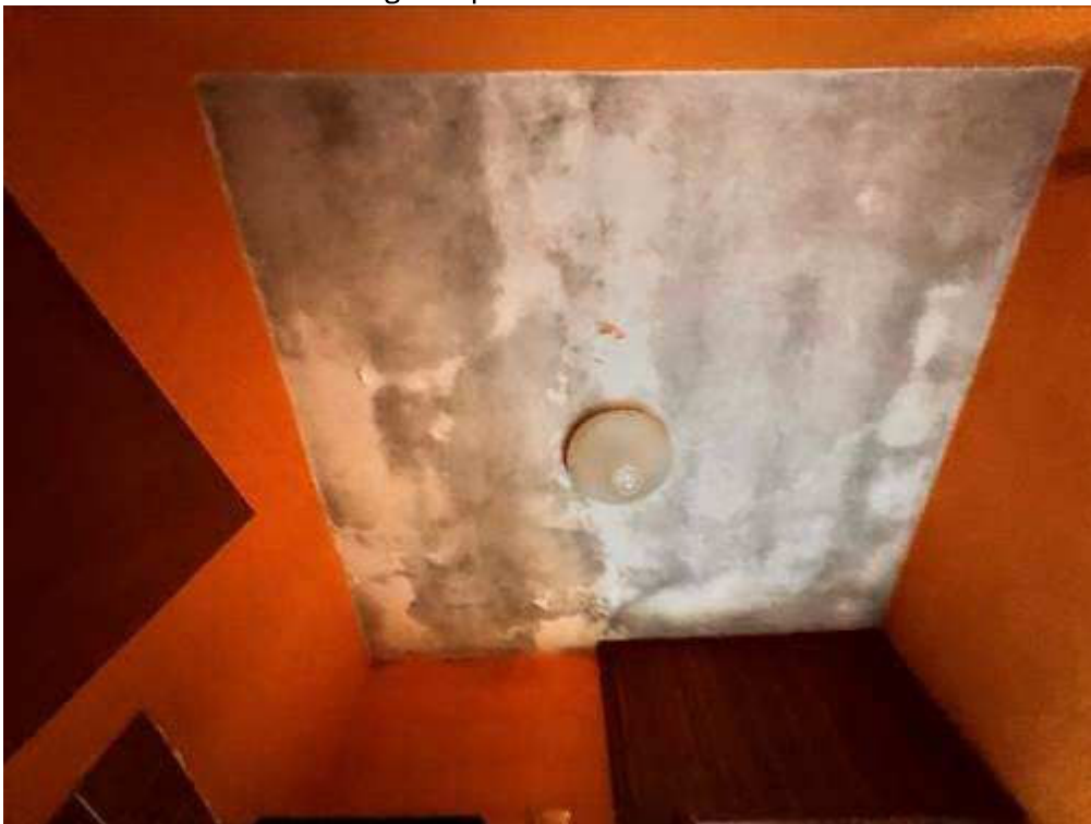
LOTTO 1 – CORPO B - Vista interna bagno – particolare muffa a soffitto
