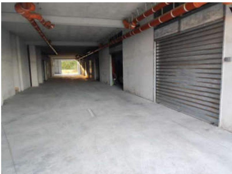
Fig. 17: Foto accesso box Corsia NORD
