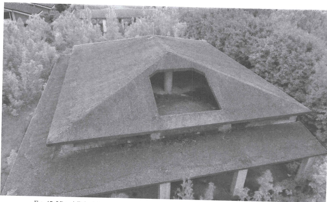
Foto 17. Vista dall'alto dell'apertura sulla copertura del fabbricato denominato "Corpo 1" non prevista in progetto
