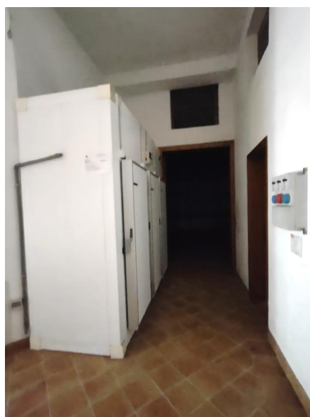
Ingresso e celle frigorifere
