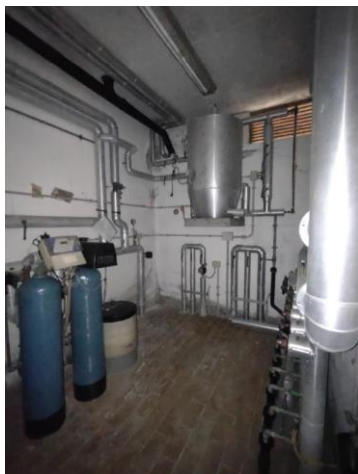
Locale impianto idrico
