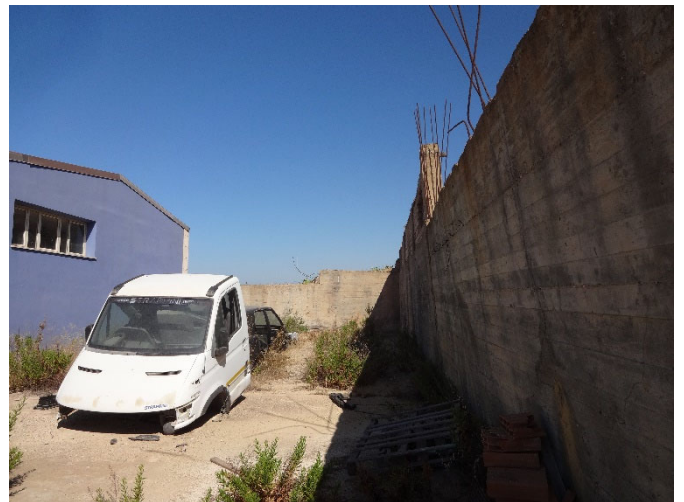
Foto 26-Muro in cemento armato a breve distanza dal fabbricato (notevolmente deformato dalla spinta del retrostante terrapieno)
