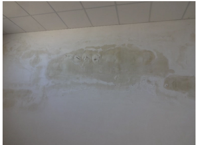
Foto 42-Particolare degli Interni (si noti la presenza di umidità)
