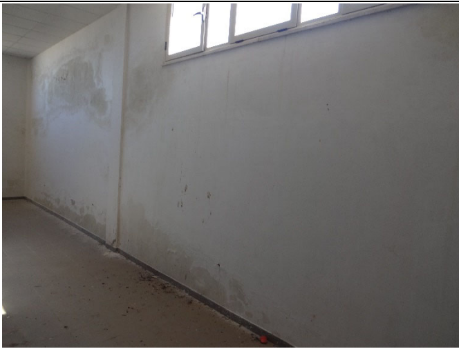
Foto 41-Particolare degli Interni (si noti la presenza di umidità)
