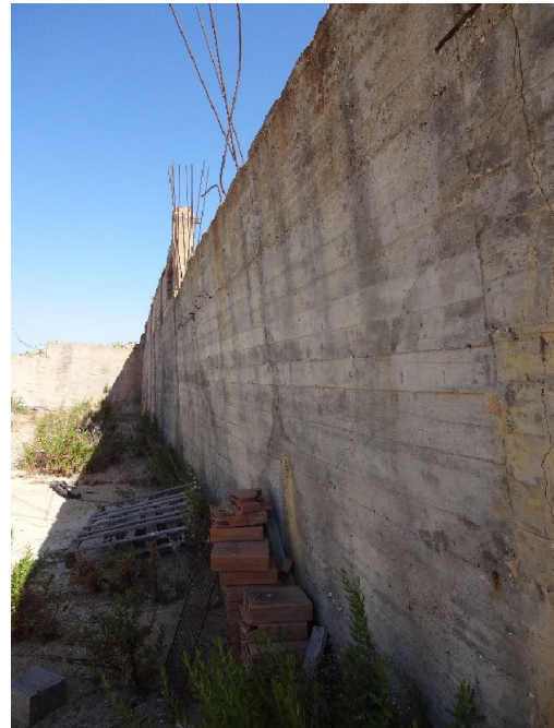
Foto 23Muro di contenimento in cemento armato posto in prossimità del fabbricato (notevolmente deformato dalla spinta del retrostante terrapieno)
