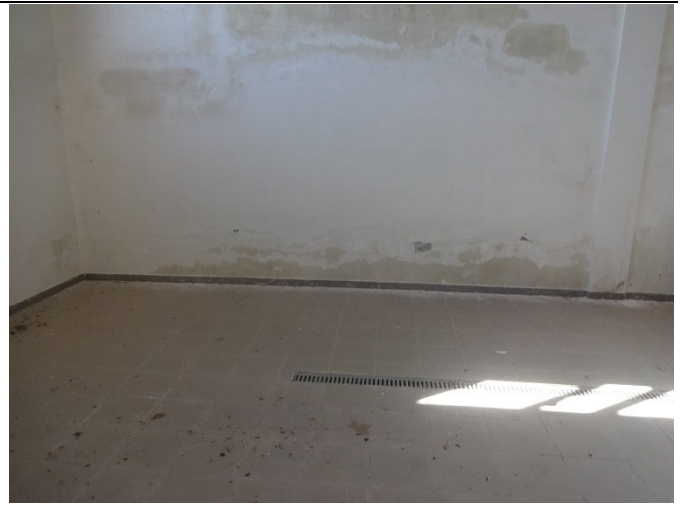
Foto 40-Particolare degli Interni (si noti la presenza di umidità)
