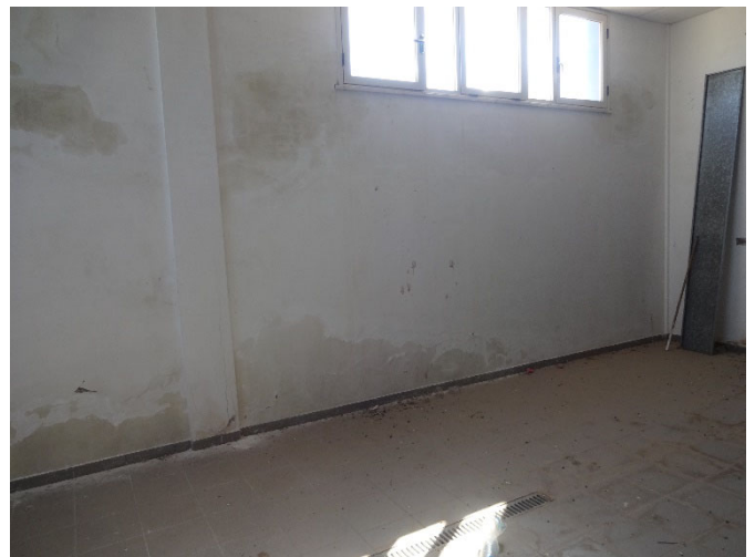
Foto 38-Particolare degli Interni (si noti la presenza di umidità)
