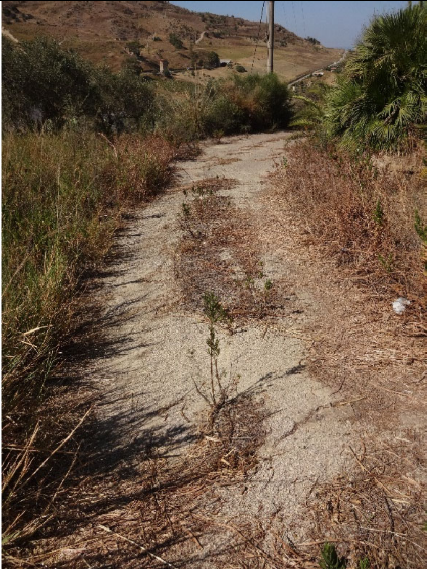
Foto 14-Viabilità interna al terreno (dissestata)
