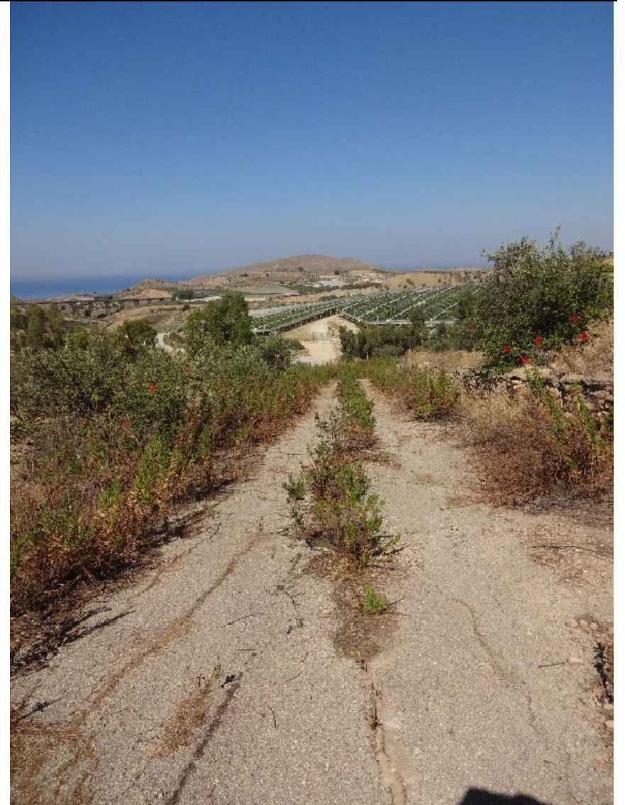
Foto 15-Viabilità interna al terreno (dissestata)
