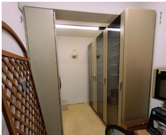
Locale quadri elettrici
